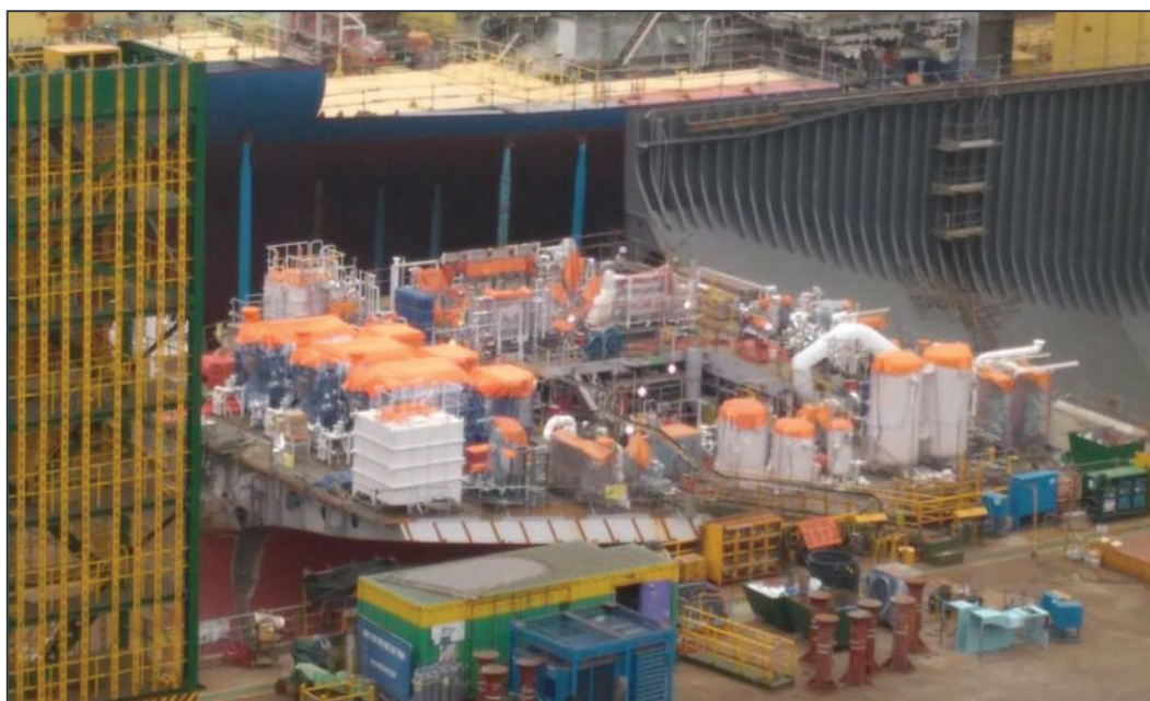
Figura 94 – Preservação da praça de máquinas coreana
