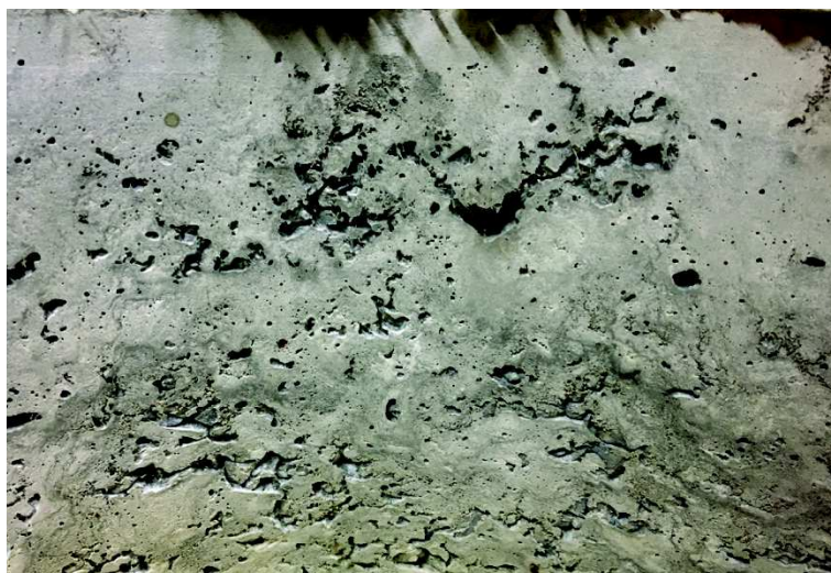
Figura 47 – Vazios de concretagem devido a dificuldade de adensamento do compósito com fibras de POL
