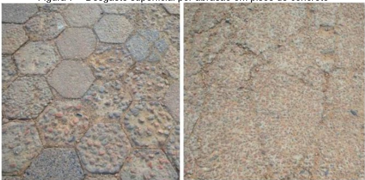
Figura 7 – Desgaste superficial por abrasão em pisos de concreto
