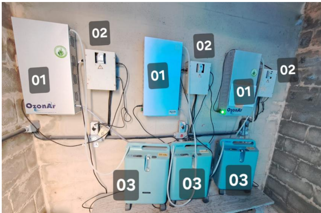
Fotografia 2 - Sistema de geração de Ozônio da ETE Unisinos
