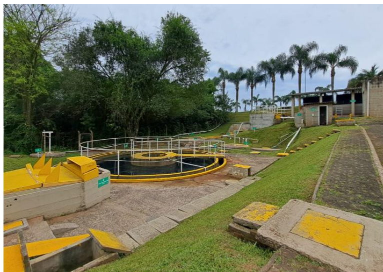
Fotografia 1 - Estação de Tratamento de Esgoto – ETE Unisinos onde o estudo foi desenvolvido
