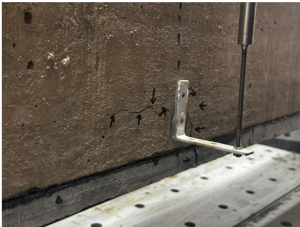
Figura 51 – Trinca na parte inferior central do reforço, com ramificações
