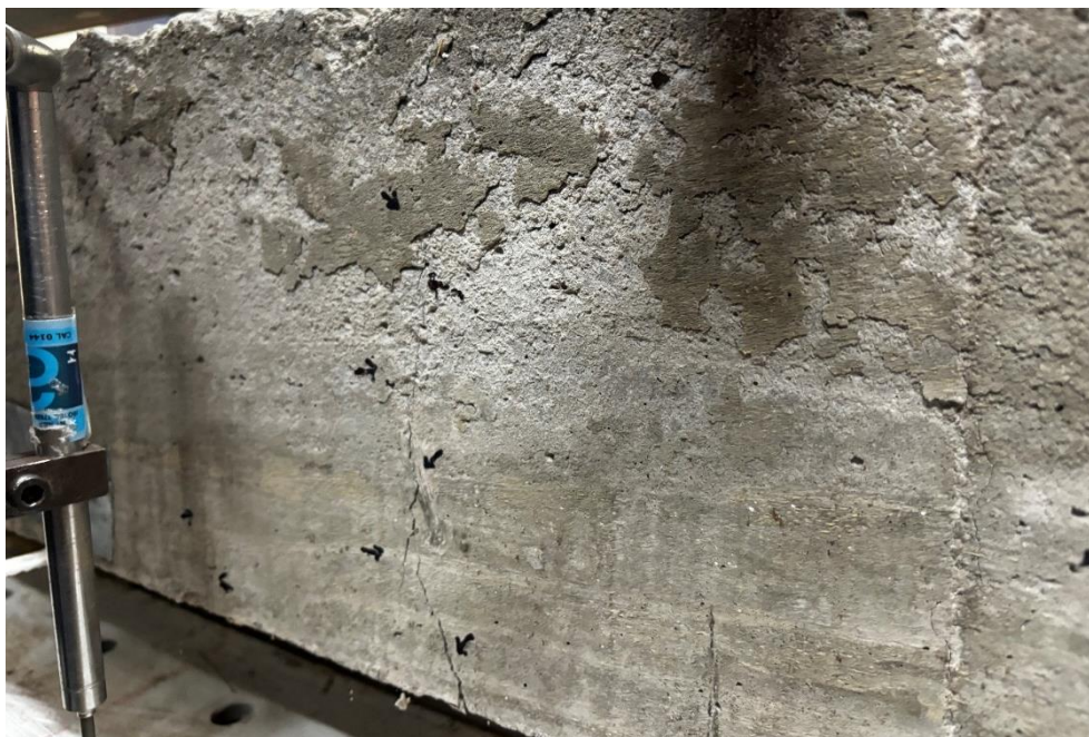
Figura 35 – Fissuração inicial, localizada na parte inferior central
