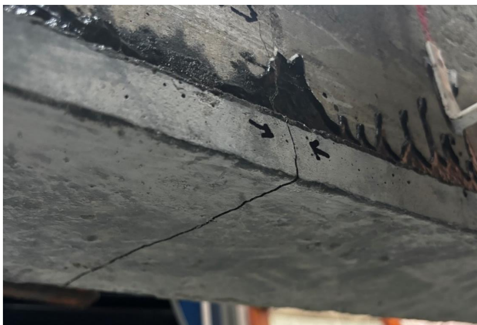
Figura 48 – Fissura vertical na parte inferior central da amostra e do reforço
