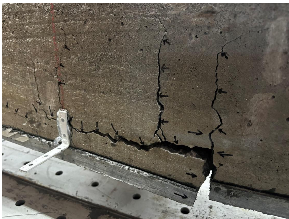
Figura 47 – Elevadas aberturas verticais e horizontais (acompanhando a armadura positiva), com grande deformação
