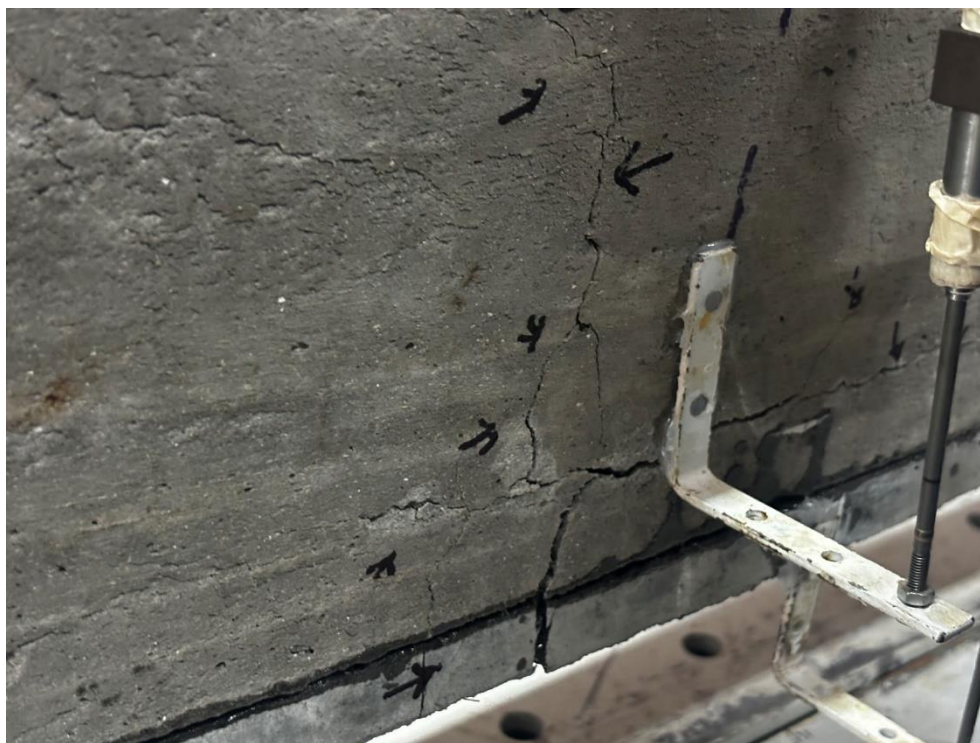
Figura 52 – Trinca na parte inferior central do reforço, com ramificações
