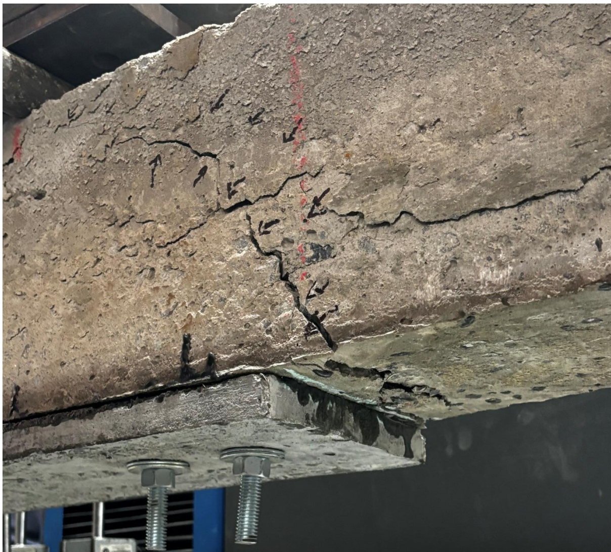
Figura 41 – Rachadura a 45° fora da área reforçada, indicando cisalhamento
