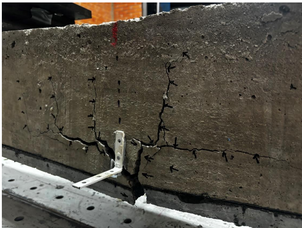
Figura 54 – Rachadura na parte inferior central do reforço, com ramificações
