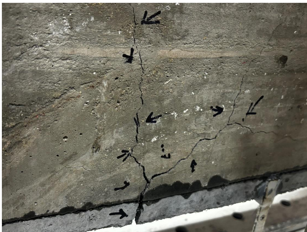
Figura 45 – Trinca na parte inferior central do reforço, com ramificações
