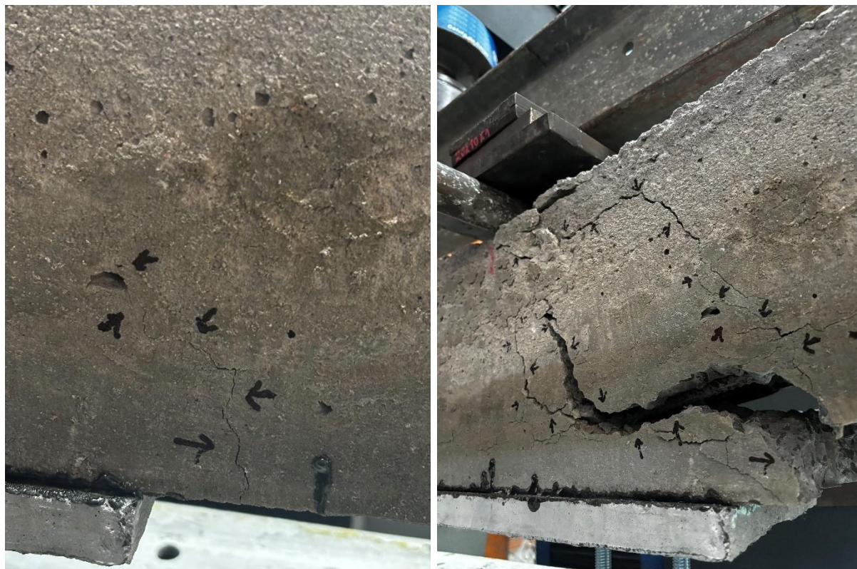
Figura 42 – Fissura (à esquerda) e fenda (à direita) fora da região do reforço
