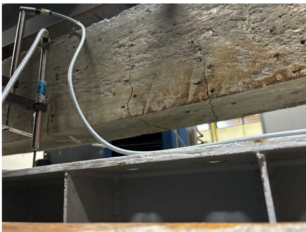
Figura 39 – Trincas verticais na base, com maiores abertura na parte central
