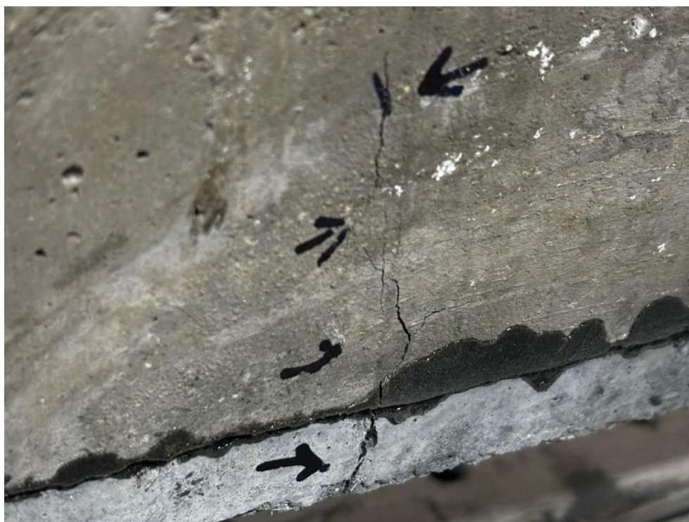
Figura 43 – Fissura vertical na parte inferior central da amostra e do reforço
