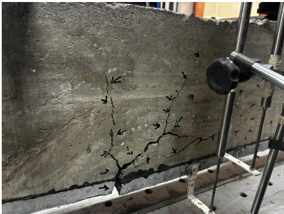
Figura 46 – Trinca na parte inferior central do reforço, com ramificações
