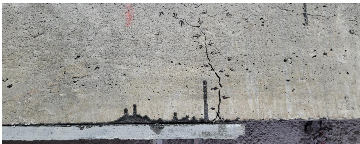
Figura 62 – Trinca vertical em viga, acima de trecho com má colagem da chapa
