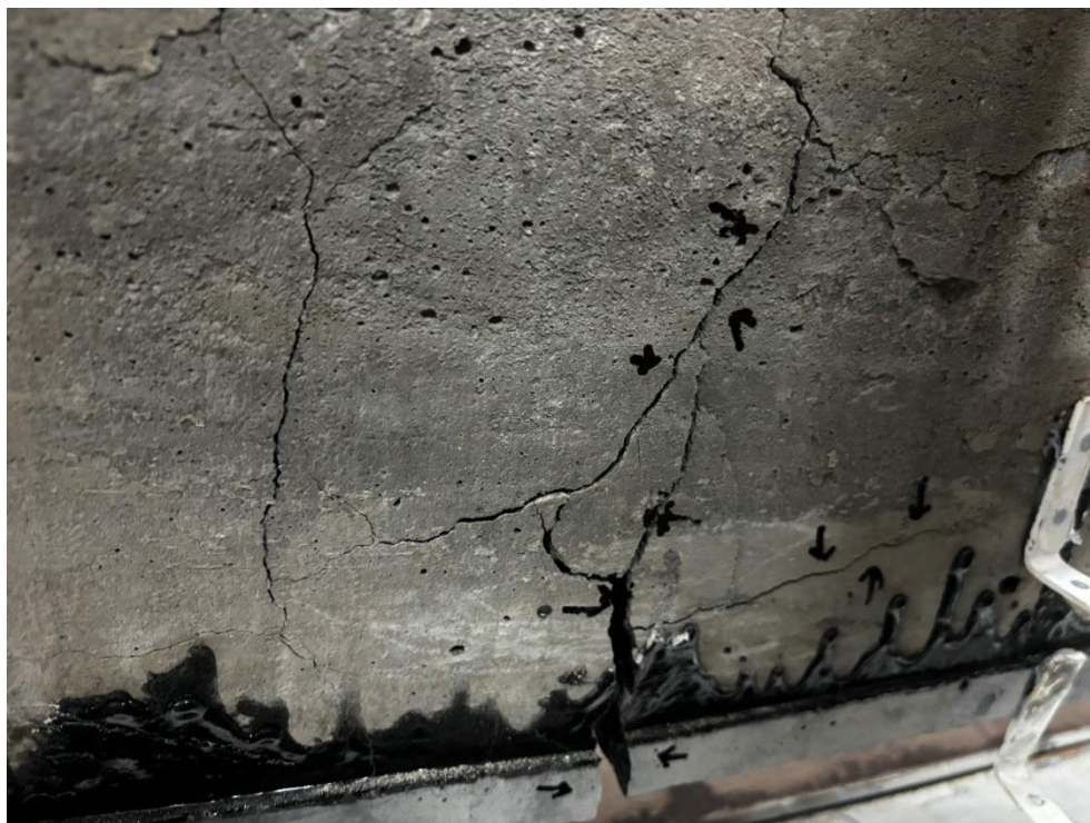
Figura 49 – Trinca na parte inferior central do reforço, com ramificações
