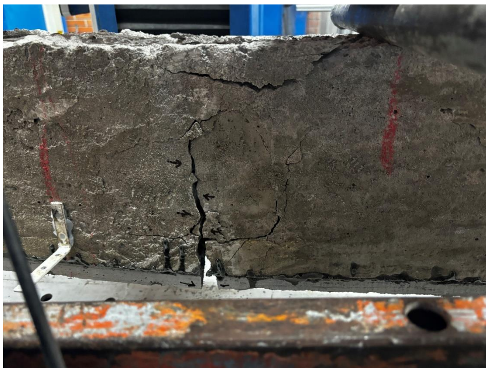
Figura 50 – Trinca na parte inferior central do reforço, com ramificações, e esmagamento de concreto na parte superior, em virtude de compressão
