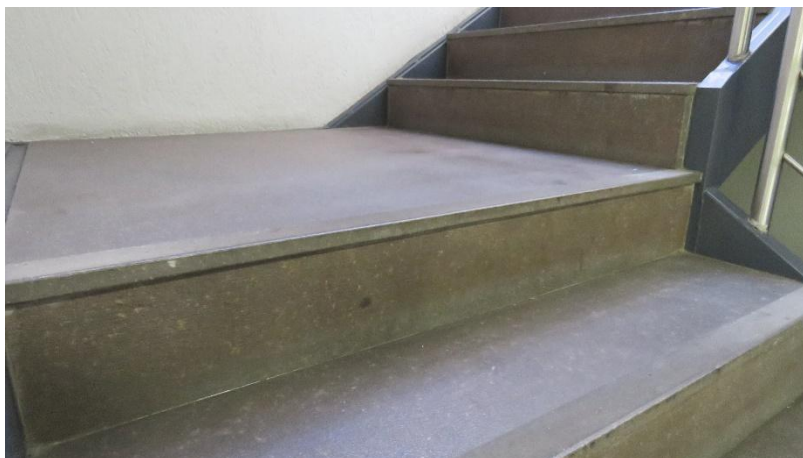
Figura 60 - Ausência de fita de contraste no espelho e no piso de cada degrau
