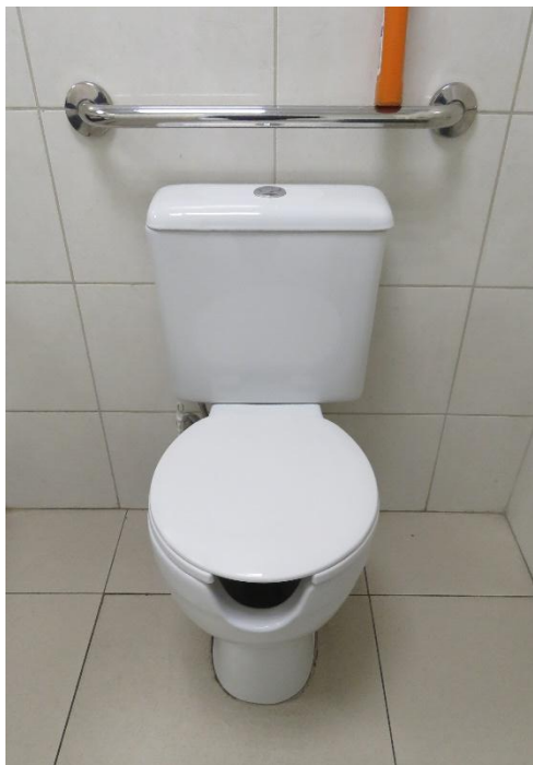
Figura 61 - Modelo obsoleto de bacia sanitária
