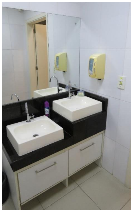
Figura 42 – Gabinete do lavatório
