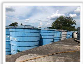
Fotografia 11: Armazenamento de água Usina 3
