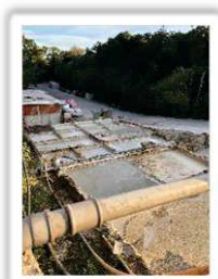
Fotografia 14: Tanques de decantação de água servida do concreto
