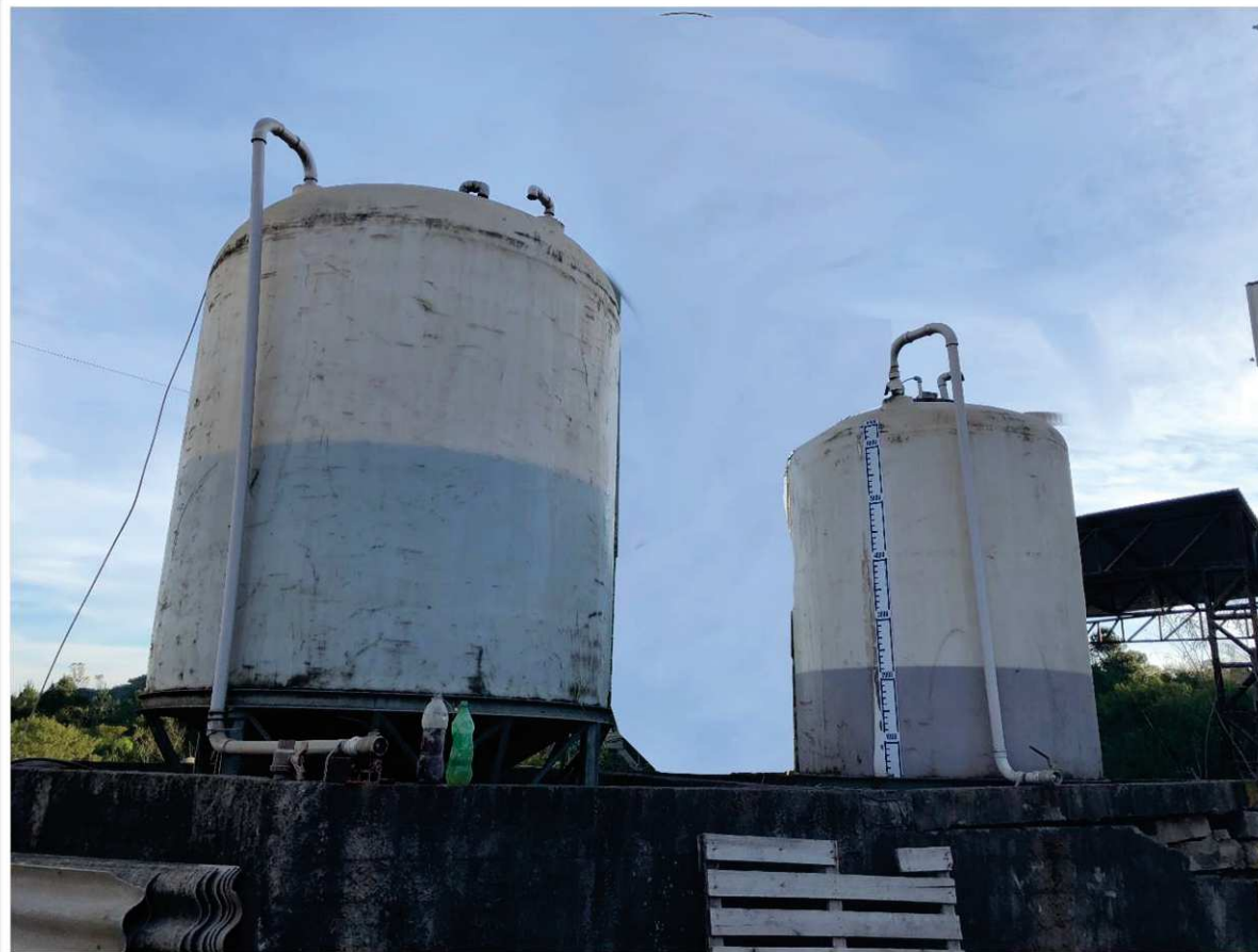
Fotografia E: Tanques de estocagem de aditivos
