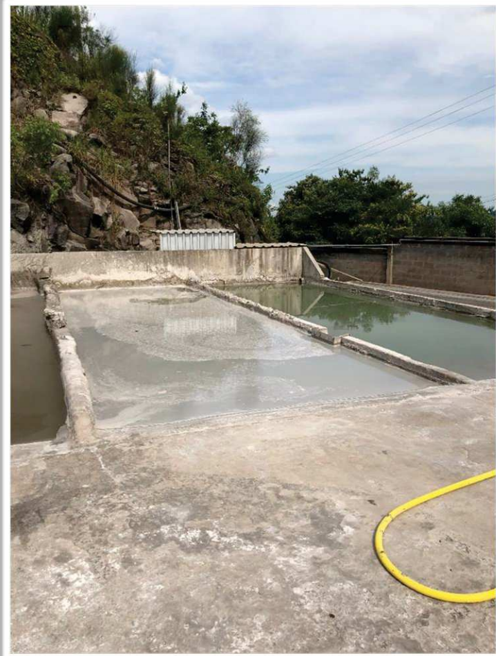
Fotografia N: Tanque de decantação de água de limpeza das betoneiras
