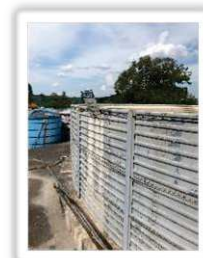
Fotografia 12: Tanques de armazenamento de água Usina 3
