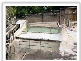
Fotografia 13: Tanque de decantação de água servida do concreto
