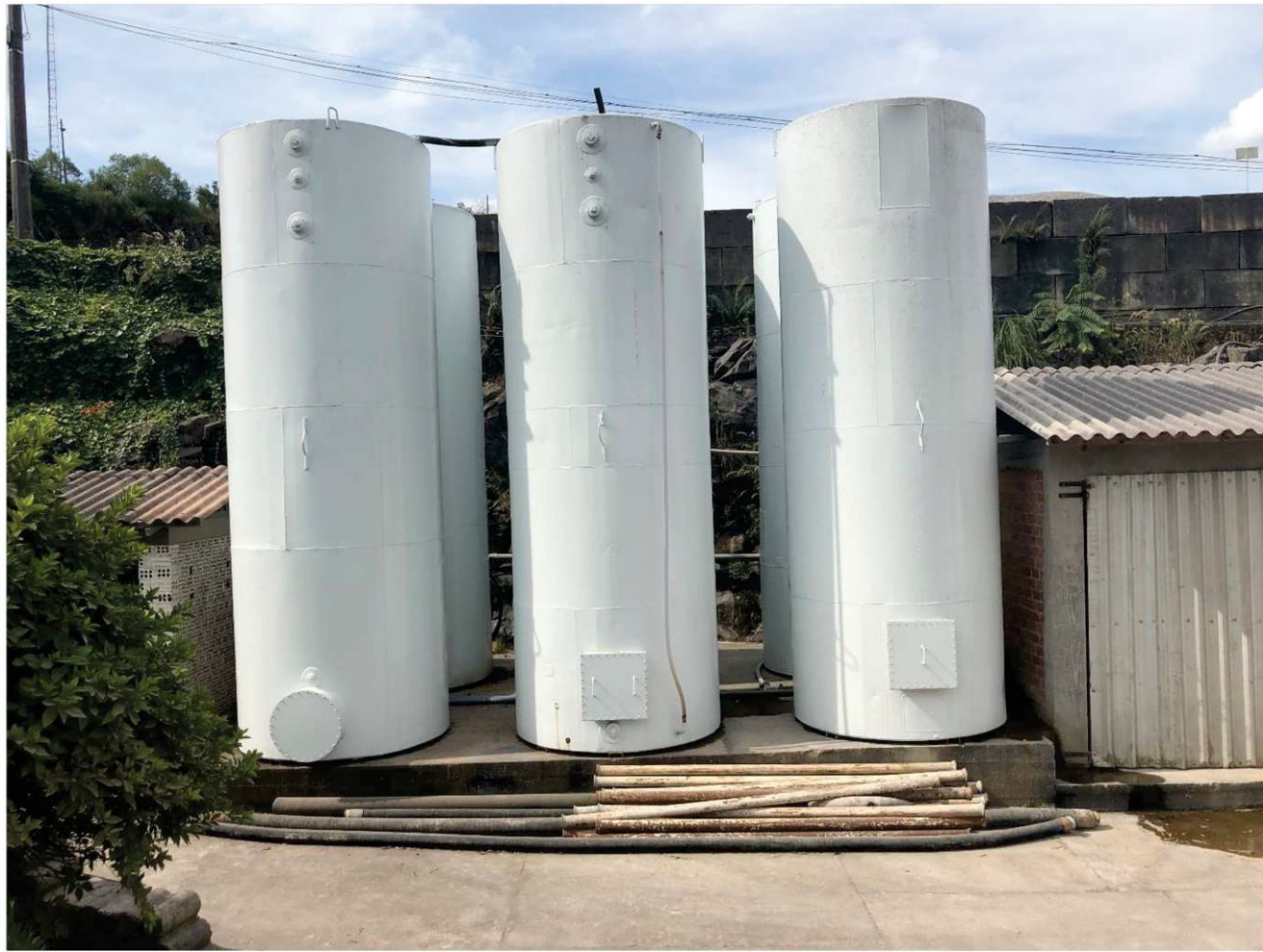
Fotografia L: Silos de estocagem de aditivos a granel
