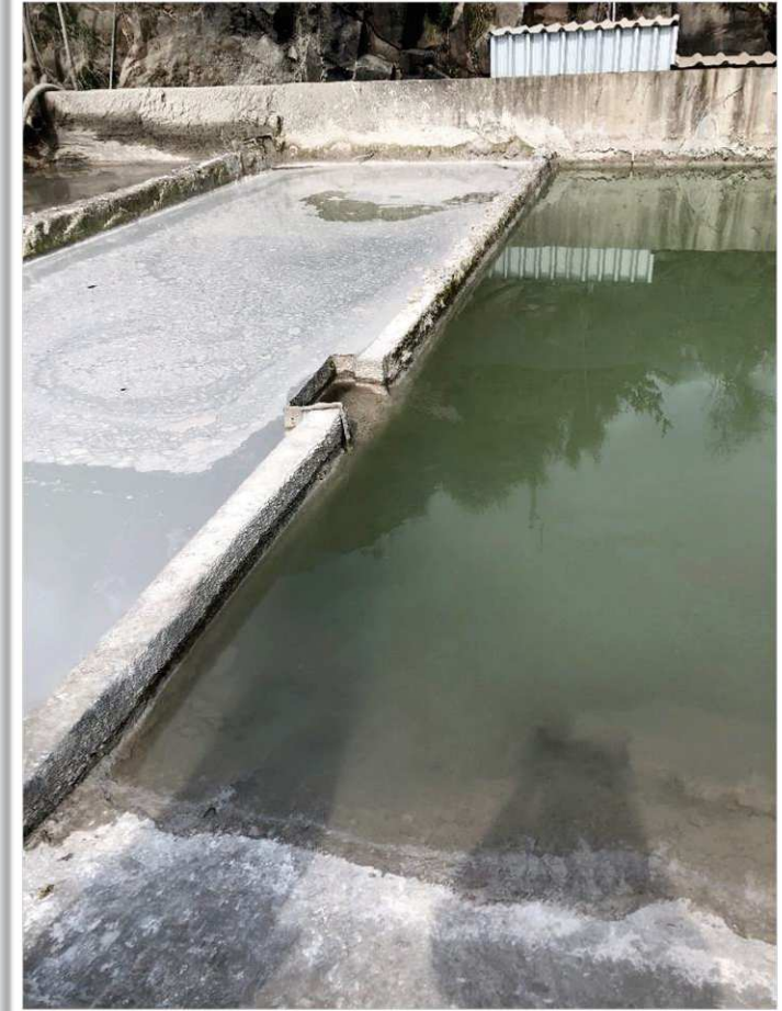
Fotografia Q: Tanque de decantação da água de limpeza das betoneiras
