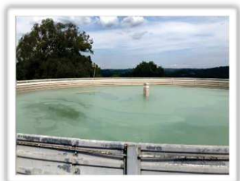
Fotografia 10: Tanque de armazenamento de água Usina 3
