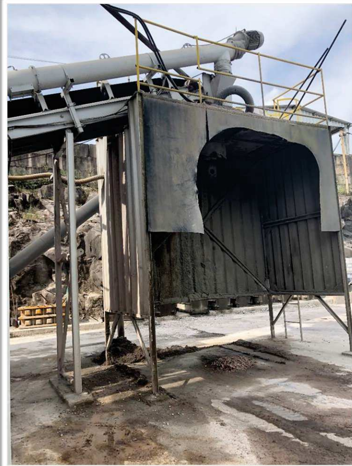
Fotografia M: Cabine de carregamento das betoneiras
