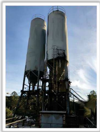
Fotografia 1: Silo de estocagem de cimento em concreteira
