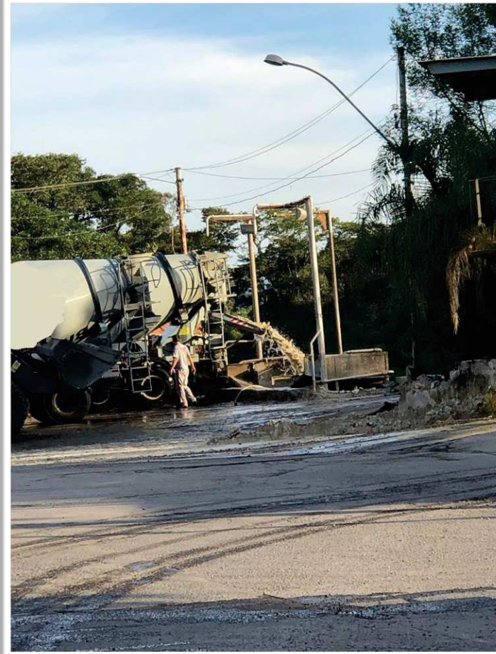
Fotografia D: Despejo de água da limpeza da betoneira
