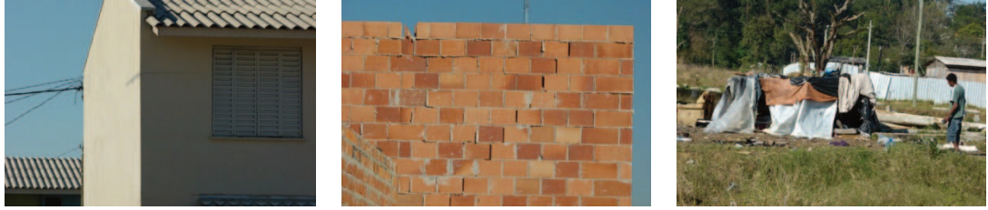
Figuras 13, 14 e 15 – Situação no reassentamento da Dique. Falhas construtivas e a cracolândia onde deveria ser a praça. Fonte: Fernando Campos Costa.
