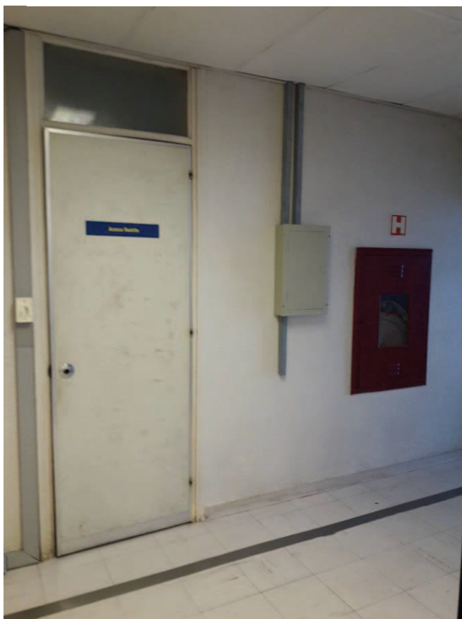
Fotografia 4 – Caixa de hidrante
