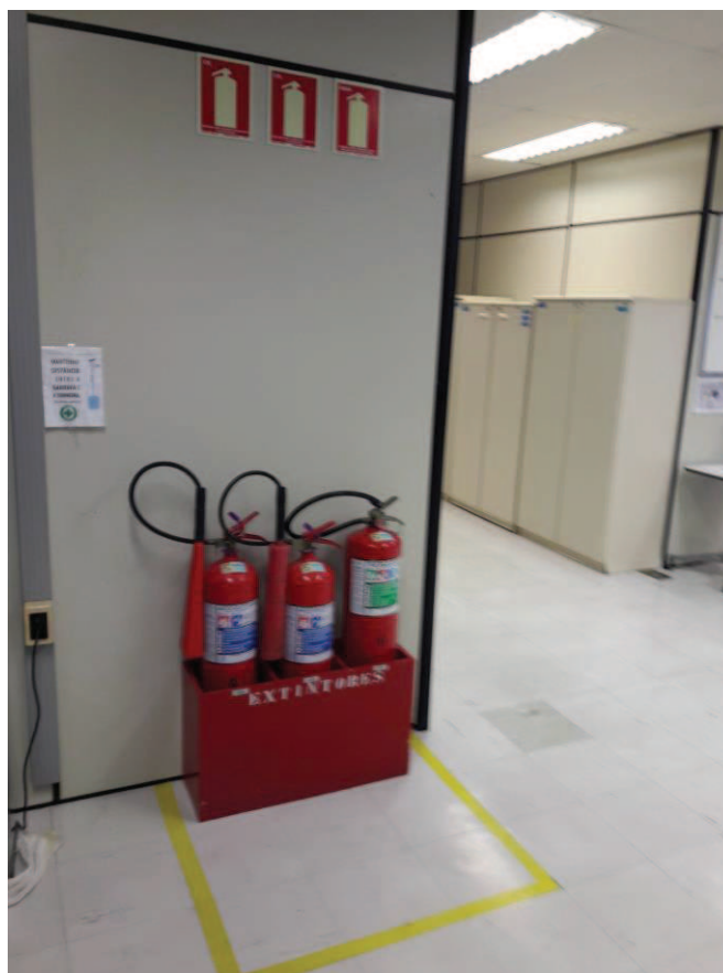
Fotografia 5 – Bateria de extintor de incêndio
