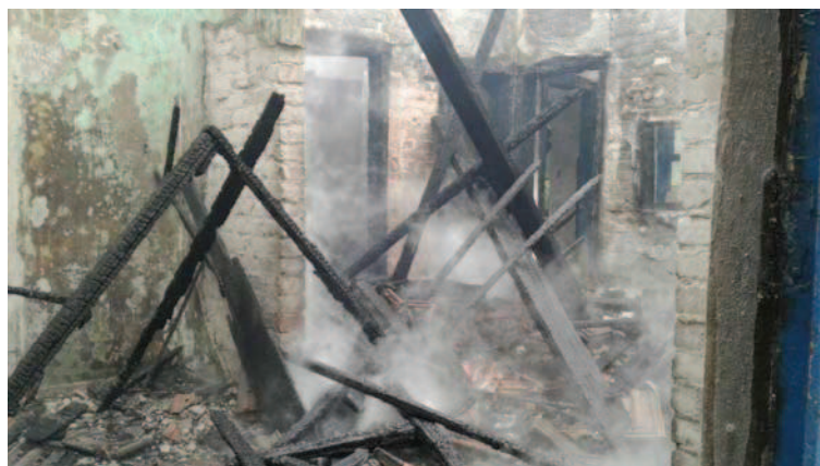
Fotografia 37 – Villa Nenê após incêndio
