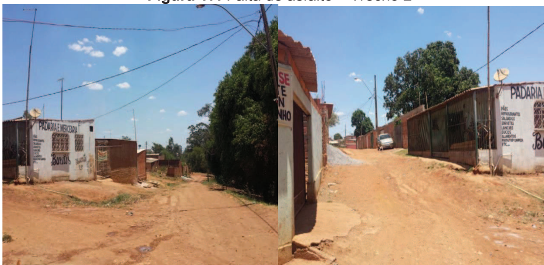
Figura 17: Falta de asfalto – Trecho 2
