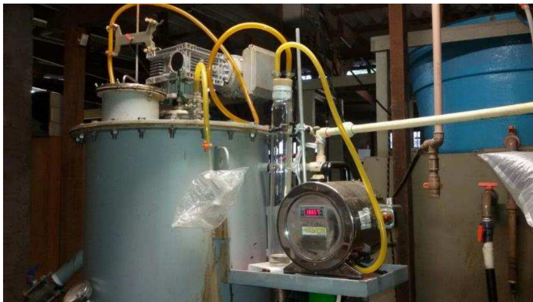
Figura 5 – Medidor de biogás
