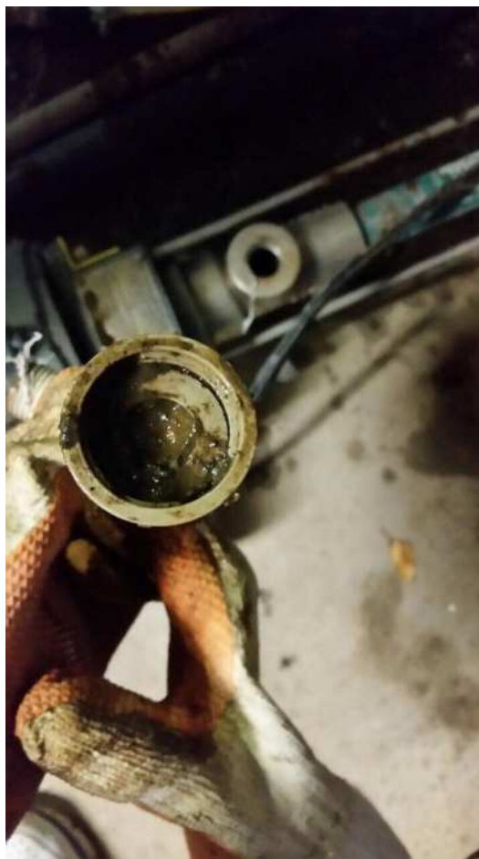
Figura 16 – Acúmulo de sólidos no encanamento que abastece o reator
