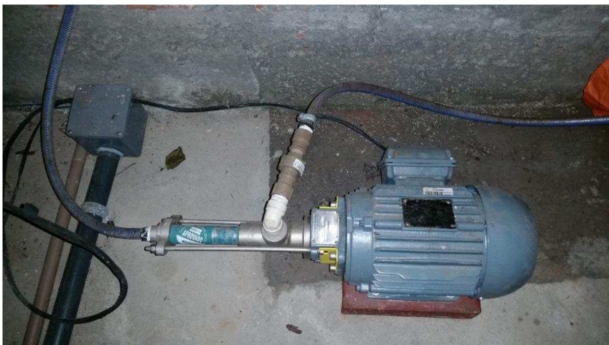
Figura 15 – Sistema de bombeamento de ES do reservatório para o reator UASB
