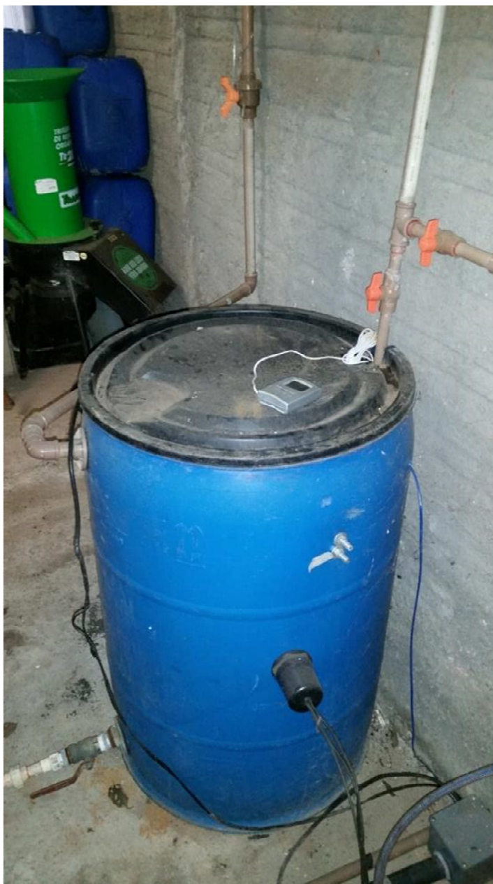
Figura 7 – Sistema de aquecimento do biodigestor
