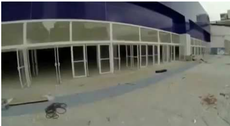
Figura 142 - Frame com imagem da fachada e entrada da Sede Mundial no Brás quando estava em construção.
