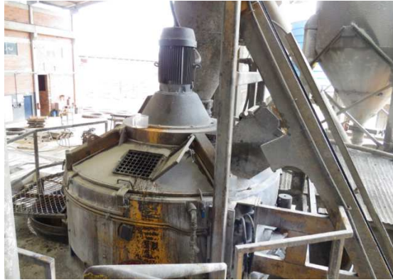
Figura 23 – Central de concreto.
