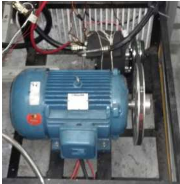
Figura 4.21: Estrutura de fixação do compressor e motor elétrico.
