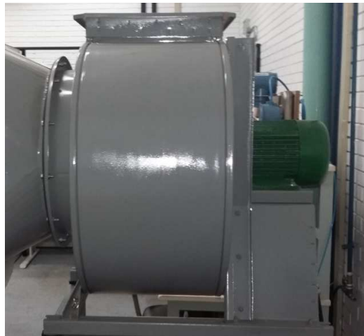
Figura 4.9: Ventilador centrífugo do túnel do condensador.
