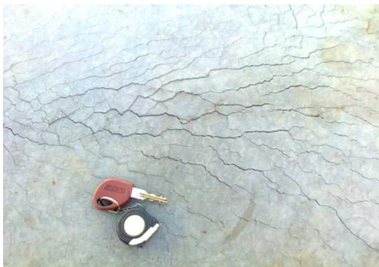
Figura 3 – Retração plástica, “pele de crocodilo”, visualizada em uma estrutura de concreto armado.
