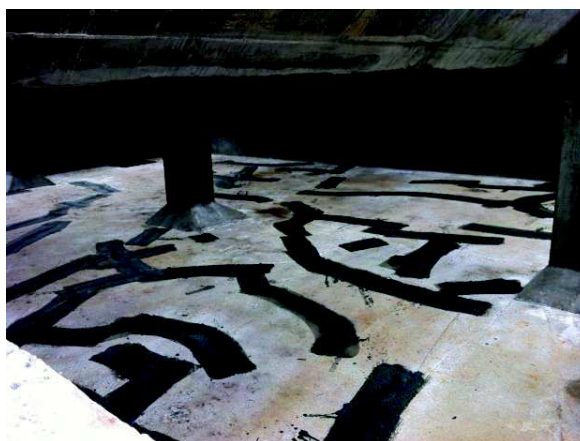
Figura 16 - Execução de reforço com argamassa polimérica e tela de poliéster, composta com PVC, como reforço em todas as fissuras de paramentos horizontais
