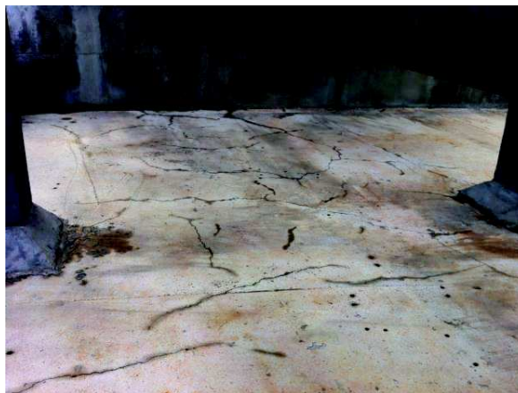
Figura 9 - Quantidade de fissuras no paramento horizontal
