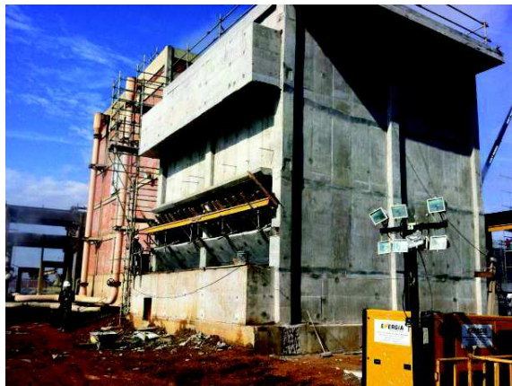
Figura 4 - ETE 1-B Complexo Industrial CMPC – Guaíba/RS
