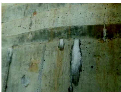
Figura 18 - Formação de eflorescência em estrutura de concreto com cimento CP-IV
