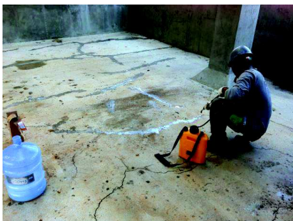
Figura 12 – 2ª hidratação com solução de acetato de Cálcio 10% nas fissuras em até 24h após a aplicação do silicato
