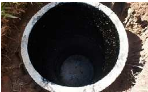
Figura 3.5: Cisterna com impermeabilizante
