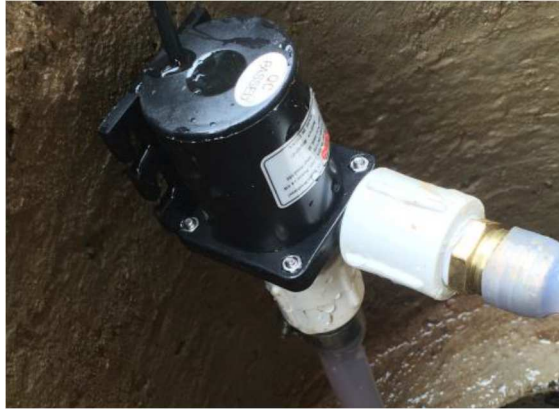
Figura 3.7: Bomba de circulação de água instalada na caixa de inspeção da cisterna
