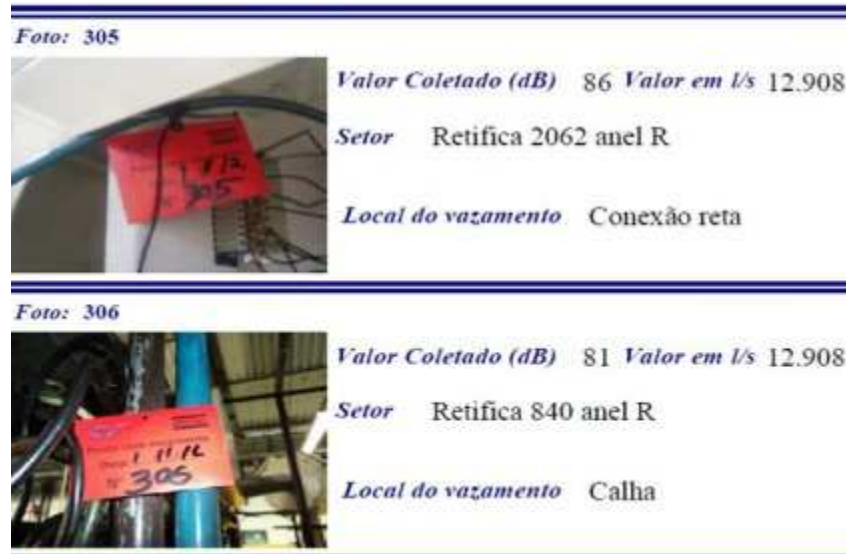
Figura 7: Identificação dos vazamentos Fonte: GKN do Brasil (2013)
