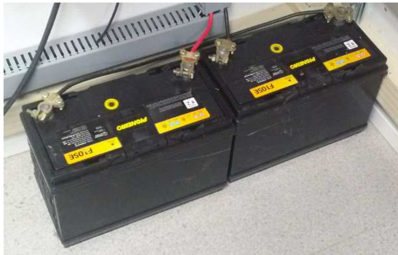
Figura 3.10 - Banco de estocagem de 24 V/100 Ah.
