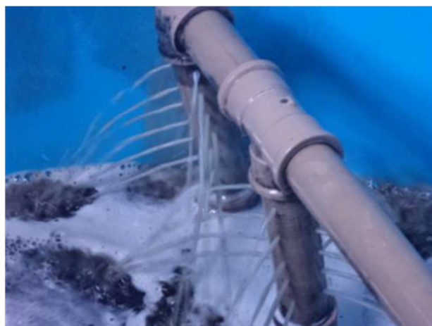
Figura 6: Sistema de distribuição de efluente ozonizado.
