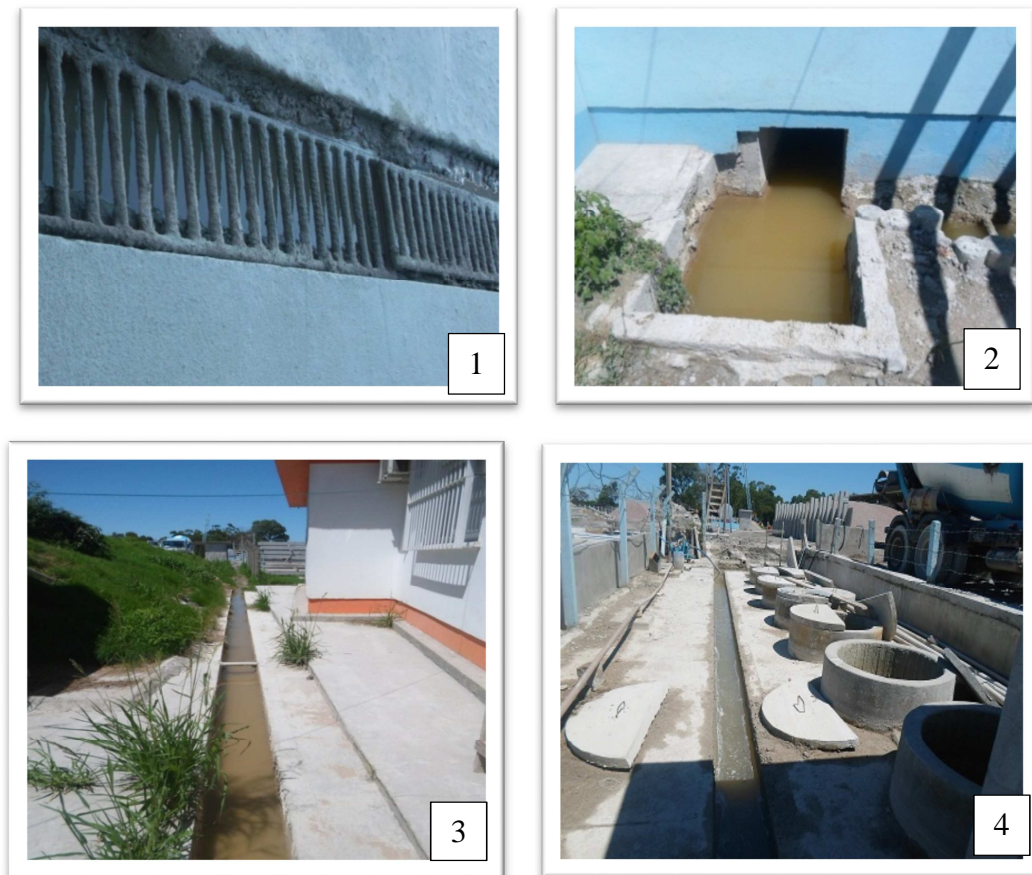
Figura 24 Processo de Reutilização da Água: 01- Canaleta por onde a água passa; 02- Primeiro tanque de decantação; 03- Canal de escoamento; 04- Tanques de separação dos efluentes.
