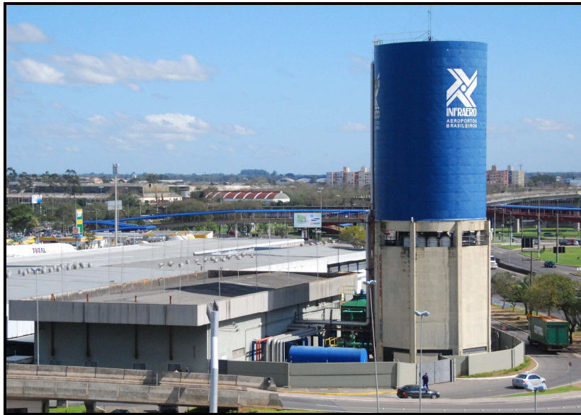
Figura 3.6 – Imagem do tanque de termoacumulação do aeroporto
