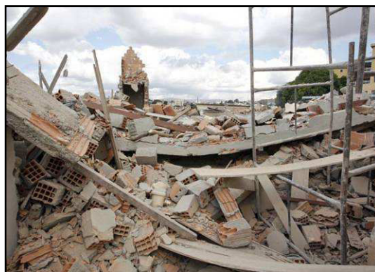
Figura 2 - Resíduo de Construção.
