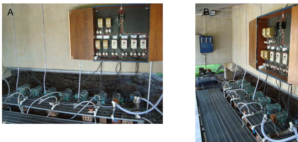
Figura 8: Sistema de controle da alimentação – Bombas dosadoras e inversores de frequência.
