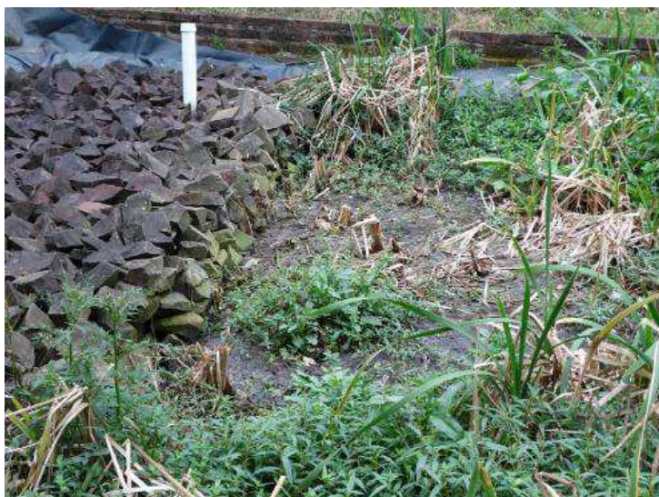
Figura 41 – Colmatação e escoamento superficial no WH2.
