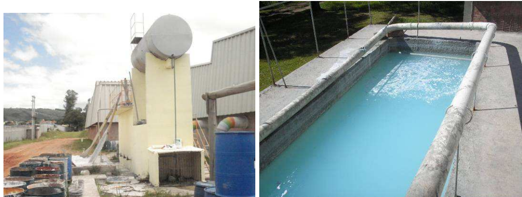
Figura 22 - Vista geral da ETE - Água tratada de ETE.
