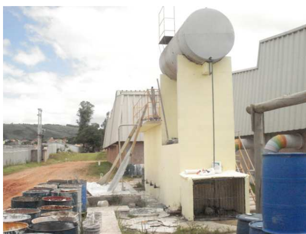
Figura 32 – ETE – Estação de Tratamento de Efluentes.
