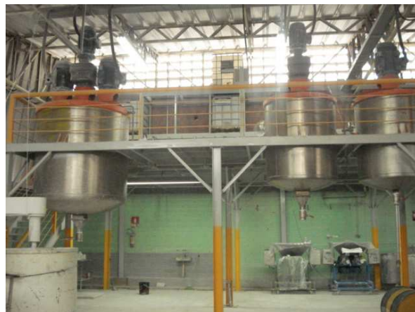
Figura 2 – Misturadores – Planta Nova.
