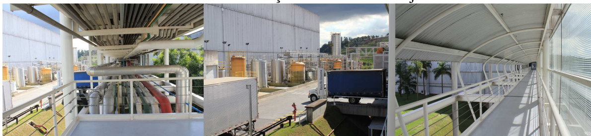
Área externa de tubulações da fábrica de Cajamar-SP
