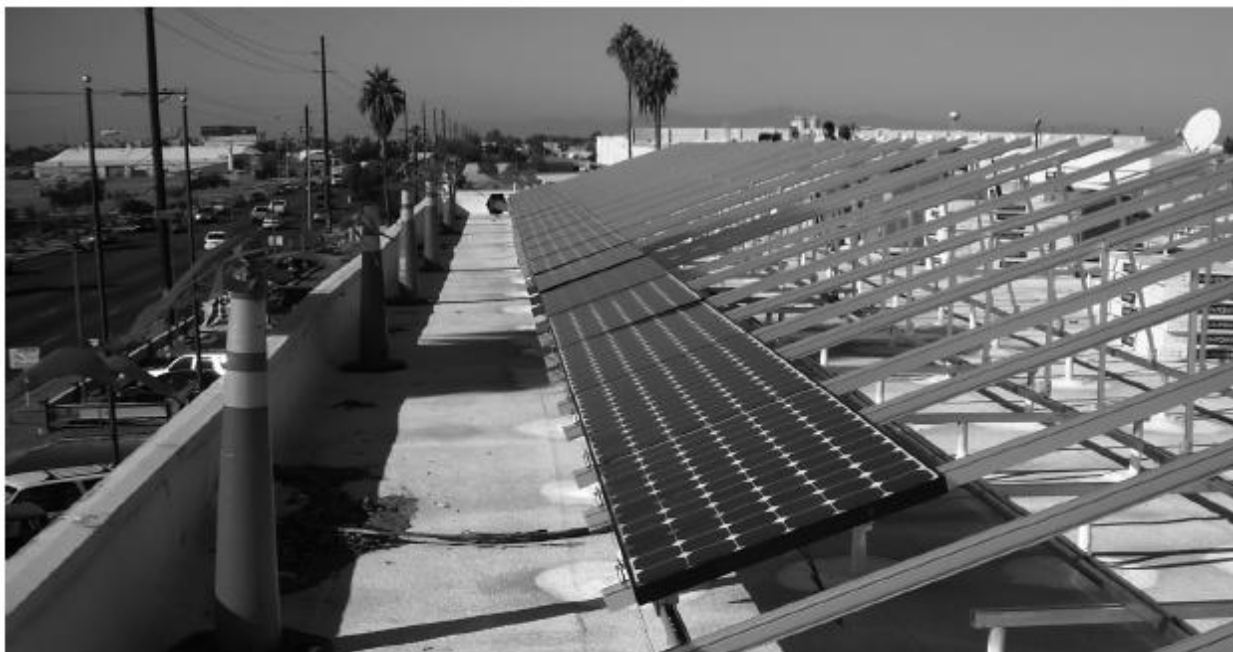
Figura 4 – Módulos FV instaladas em telhado
