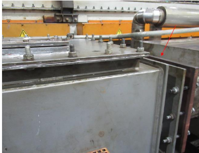
Fotografia 16 – Região de vazamento na gaxeta Módulo 1
