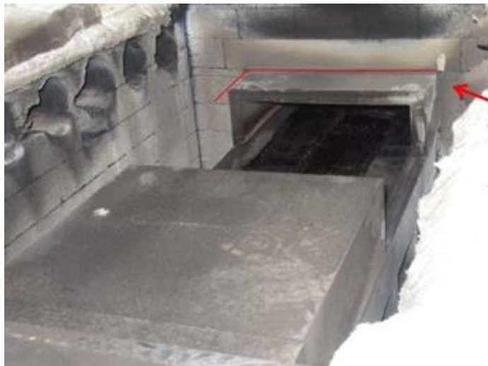
Fotografia 13 – Montagem Incorreta do Refratário
