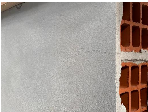
Figura 83 – Fissura na horizontal P6
