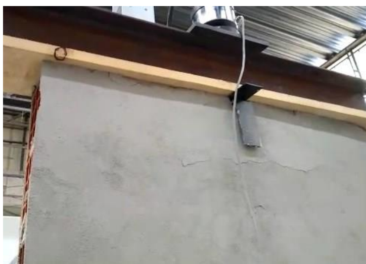
Figura 71 – Fissura horizontal P2E-a1:1:6
