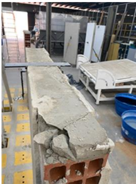
Figura 68 – Ruptura da argamassa de encunhamento
