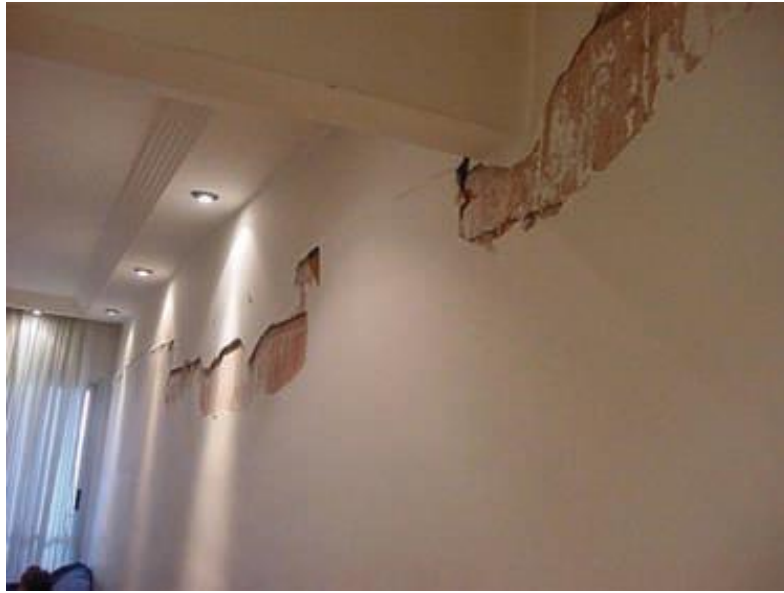
Figura 19 – Fissuras e descolamento do revestimento
