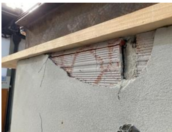
Figura 84 – Ruptura no bloco na P6
