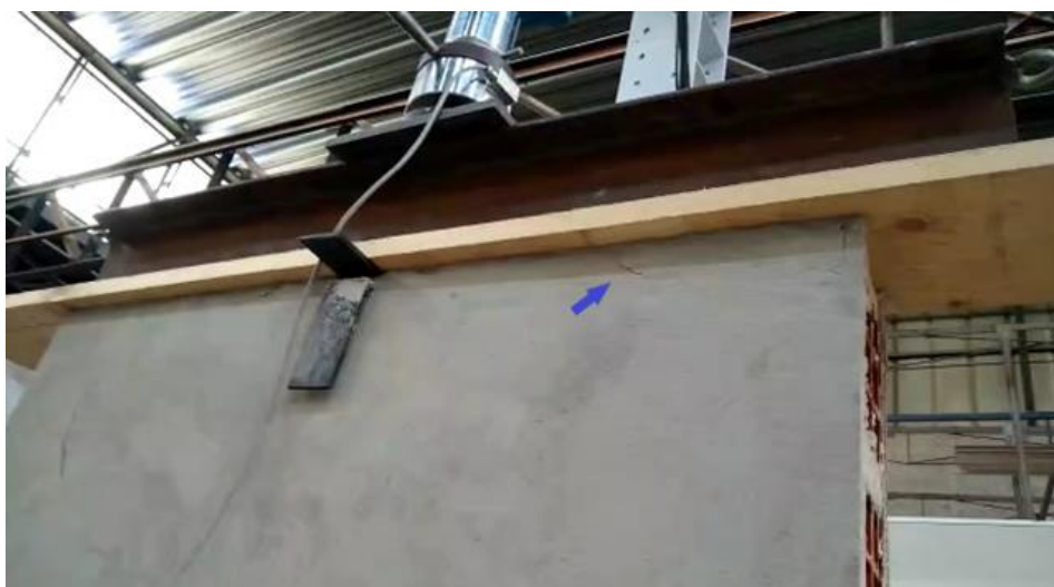
Figura 75 – P3E-esp - Fissura e queda de material a 13,91kN
