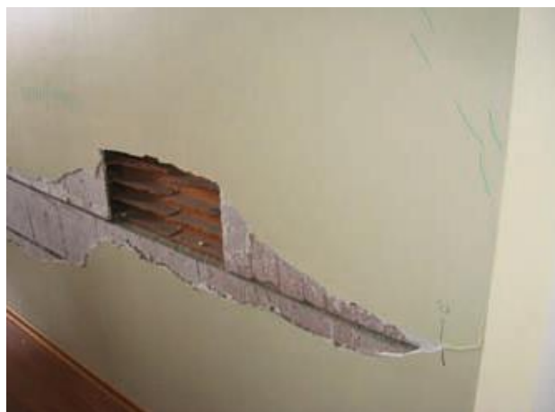
Figura 14 – Fissura e ruptura dos blocos
