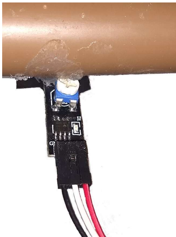
Figura 24 – Segundo sensor infravermelho instalado na extremidade do tubo de lançamento
