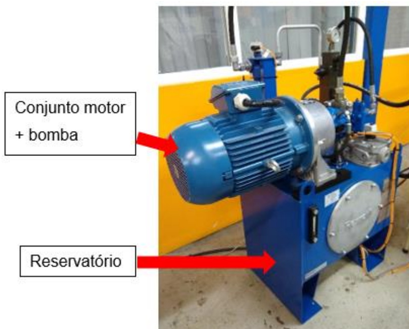
Figura 21 – Fotografia da unidade hidráulica
