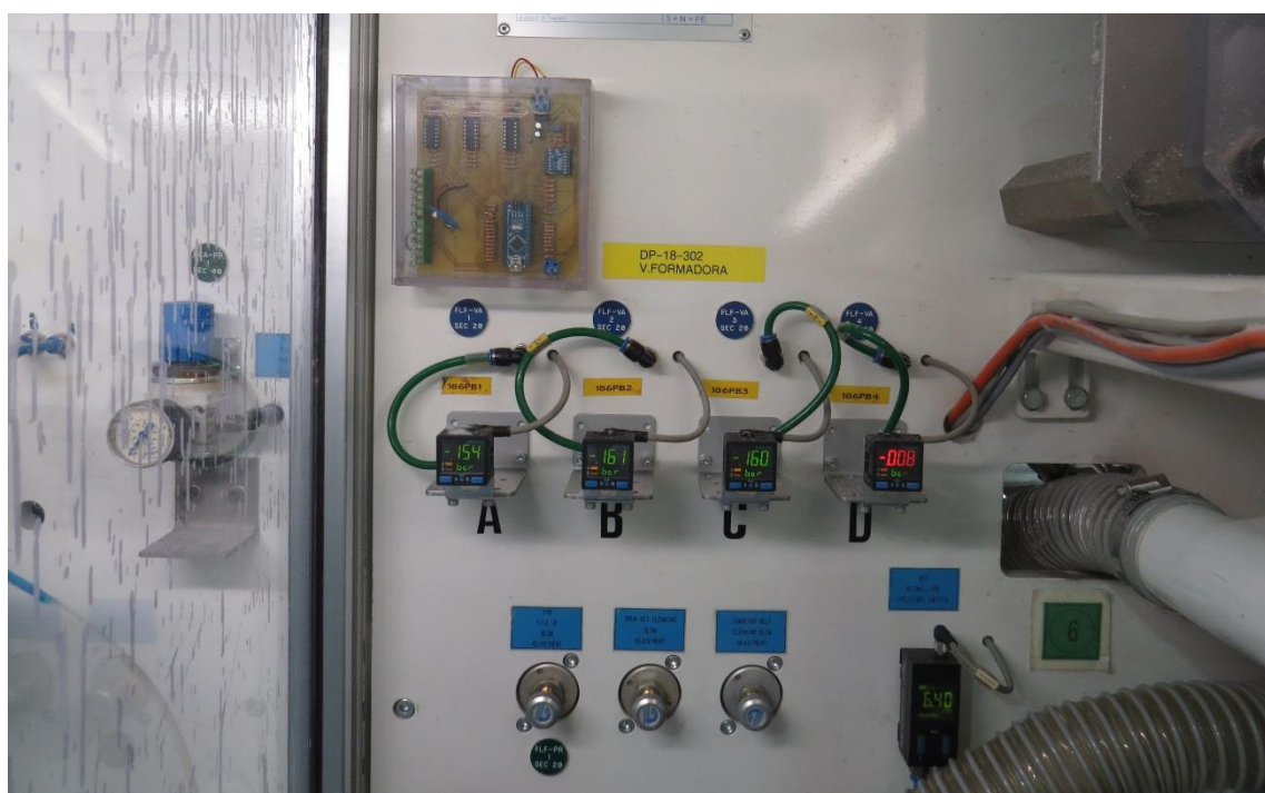
Figura 24 – Local de instalação do módulo transmissor de 100 mW
