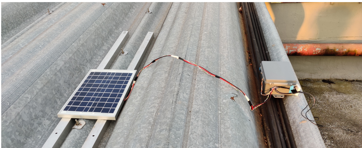
Figura 19 – Local de instalação do sistema PV
