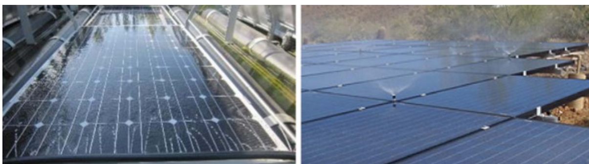
Figura 13 – Refrigeração a véu e a spray d'água
