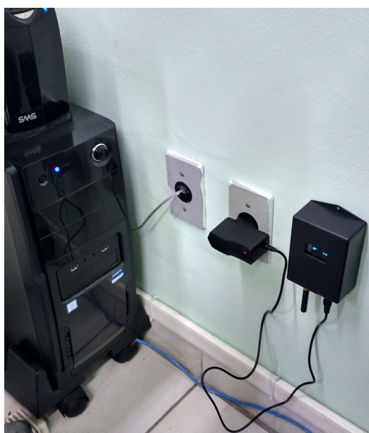
Figura 84 - Gateway instalado no escritório
