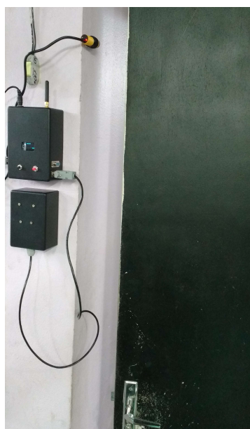
Figura 82 - Nó e sensores instalados no almoxarifado
