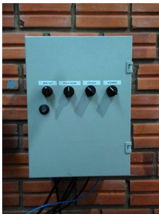
Figura 81 - Porta do quadro de comando com chaves para acionamento manual
