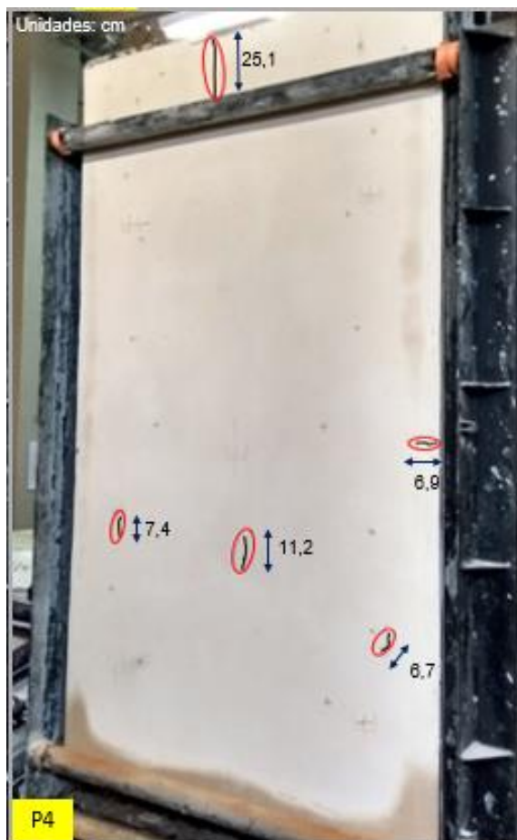
Figura 39 – Mapeamento das fissuras na amostra P4 (face exposta ao ensaio)
