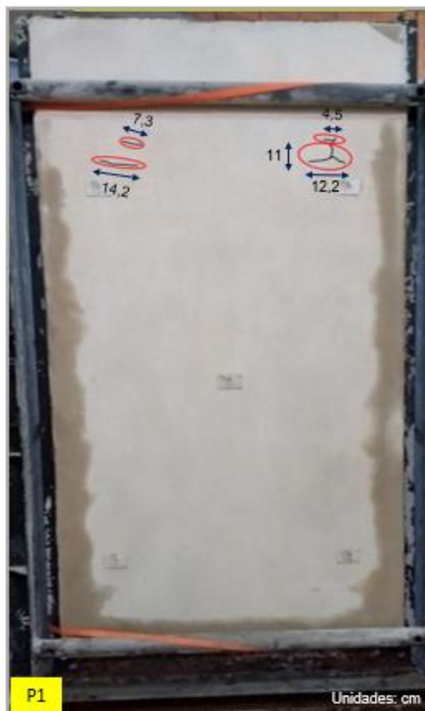
Figura 33 – Mapeamento das fissuras na amostra P1 (face exposta ao ensaio)
