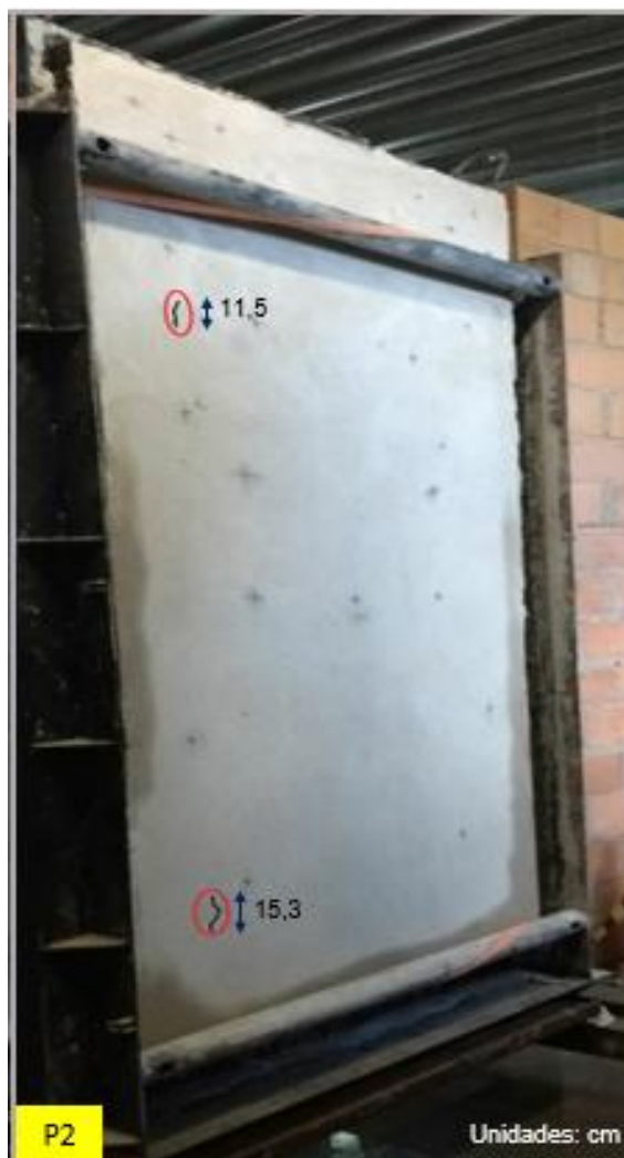
Figura 35 – Mapeamento das fissuras na amostra P2 (face exposta ao ensaio)
