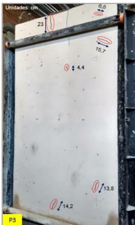
Figura 37 – Mapeamento das fissuras na amostra P3 (face exposta ao ensaio)
