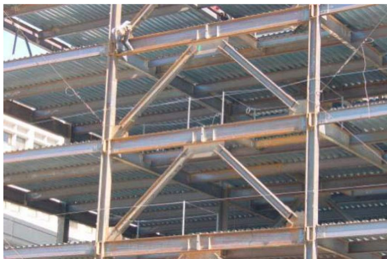
Figura 18 – Barras laminadas dispostas em forma de V invertido, formando o sistema de contraventamento do tipo Chevron
