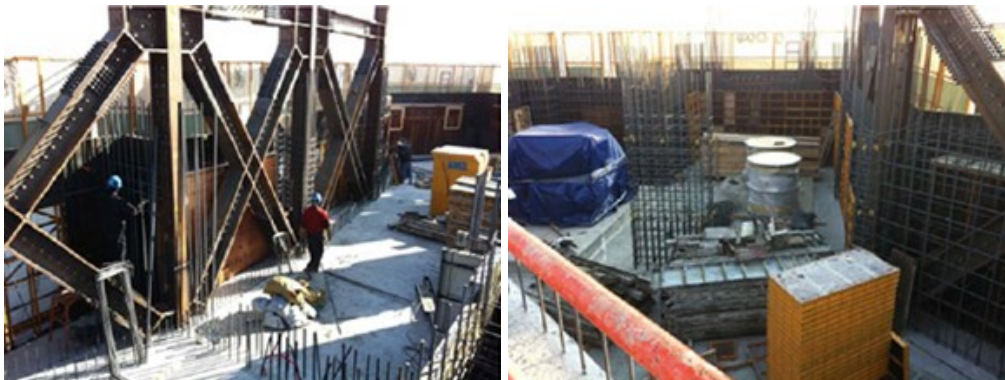
Figura 27 – Edificação mista com Outriggers e Belt Trusses reforçando um núcleo e pilares de concreto armado
