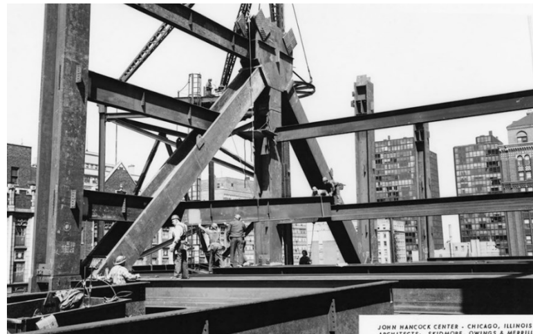
Figura 4 –Elevação do contraventamento em X na fachada Norte do John Hancock Center
