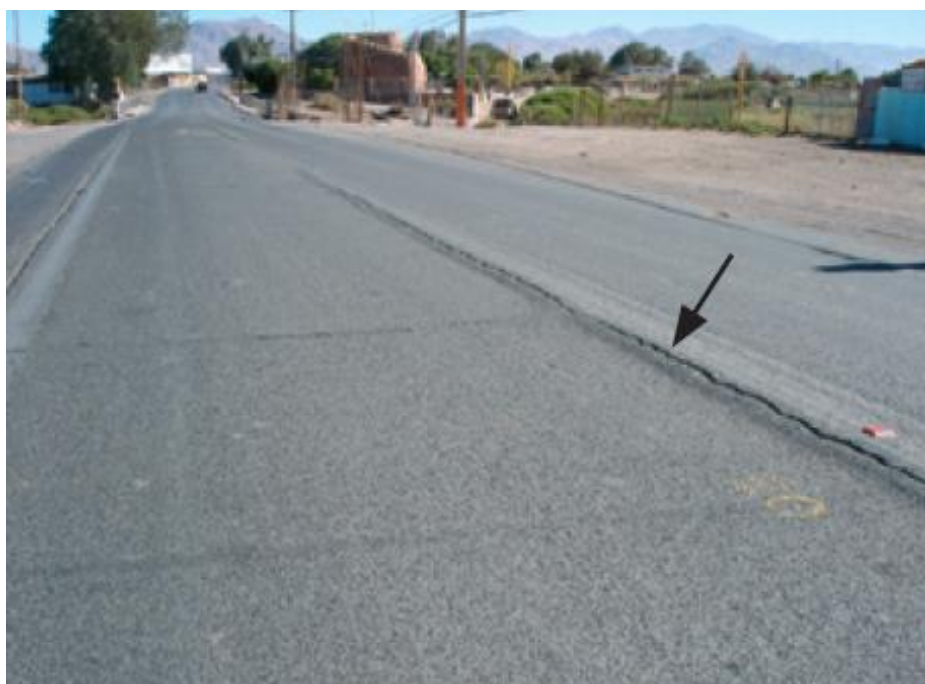
Figura 17 - Trinca de retração
