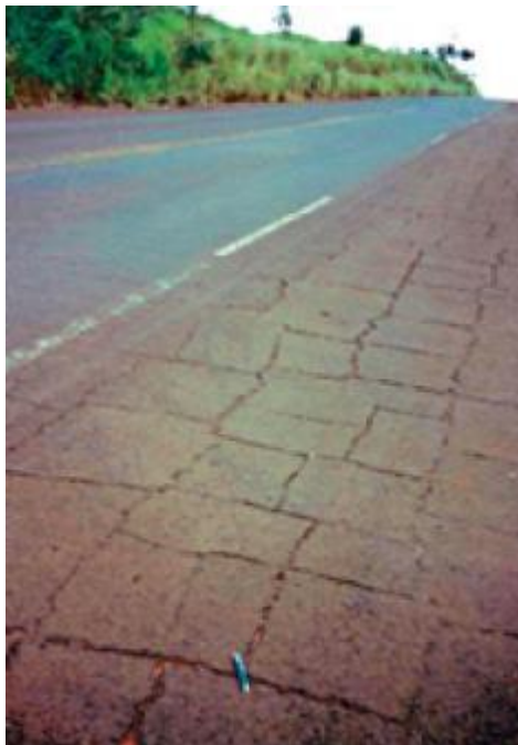
Figura 18 - Trinca em bloco sem erosão
