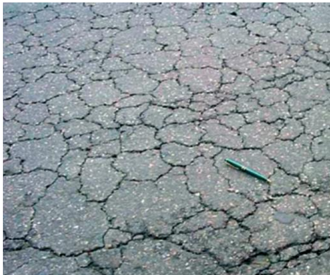
Figura 15 - Trinca “couro de jacaré”
