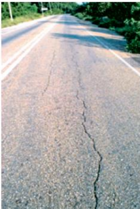
Figura 16 - Trinca longitudinal longa
