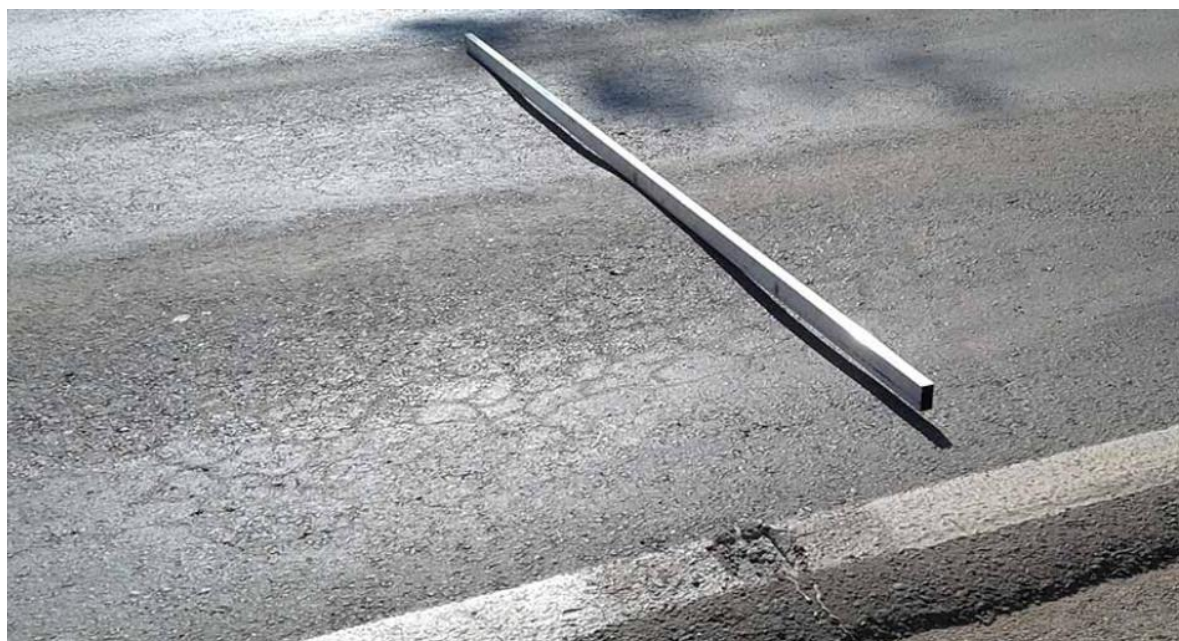
Figura 19 - Afundamento por trilha de roda
