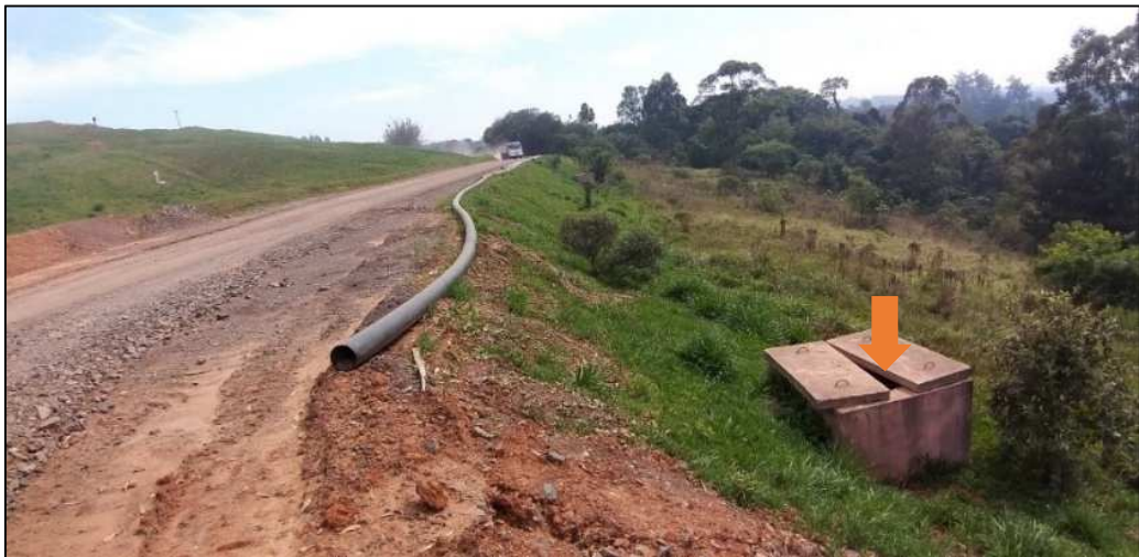
Figura 7 - Caixa de Passagem das Fases 4 e 6
