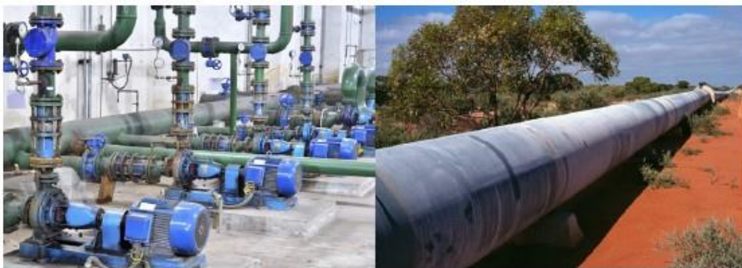
Figura 3 - Adução com bombeamento e adução de água bruta
