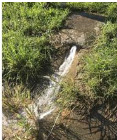
Figura 10 - Vazamento de água encontrado próximo ao viaduto, em Knoxville
