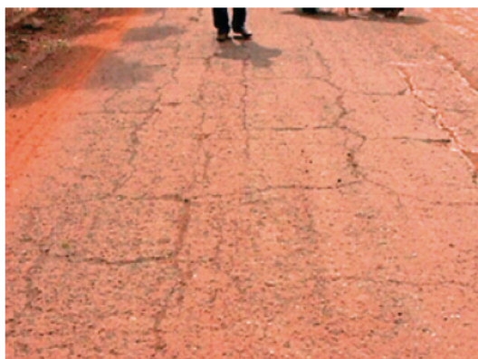
(e) Trincas de bloco com erosão (TBE)
