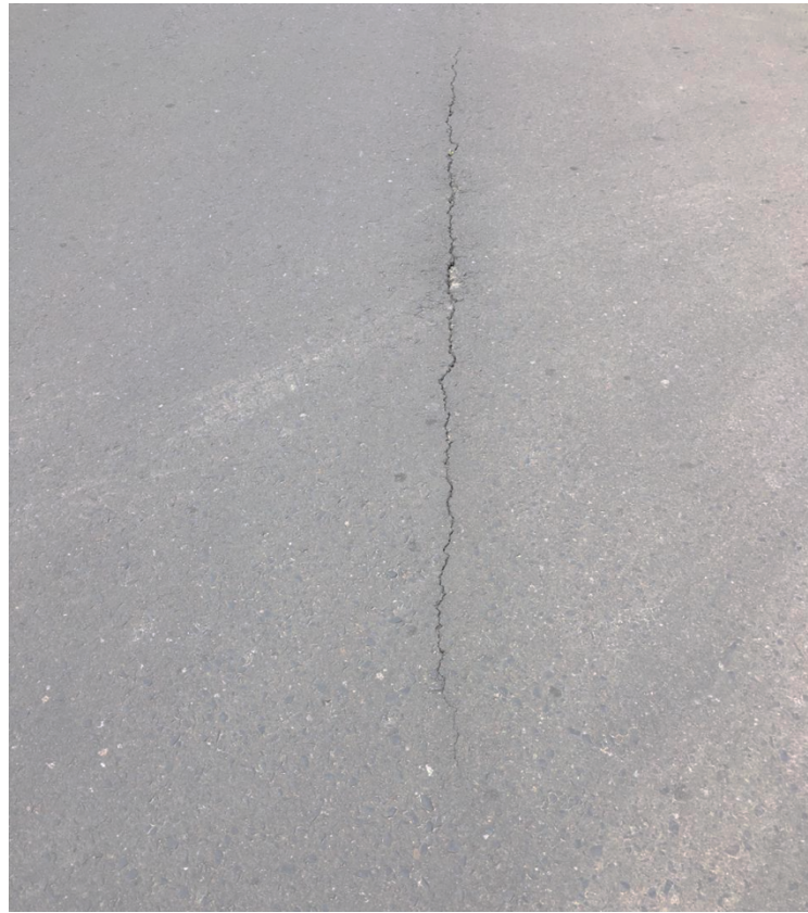
Fotografia 9 - Trinca Longitudinal Longa (TLL)
