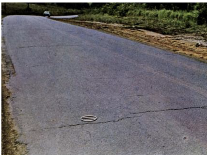
Figura 9 - Trinca Transversal (TT)
