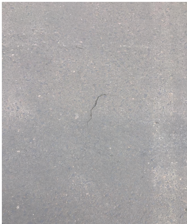
Fotografia 10 - Trinca Longitudinal Curta (TLC)
