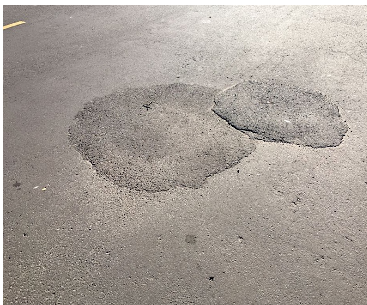
Fotografia 8 - Remendo mal executado
