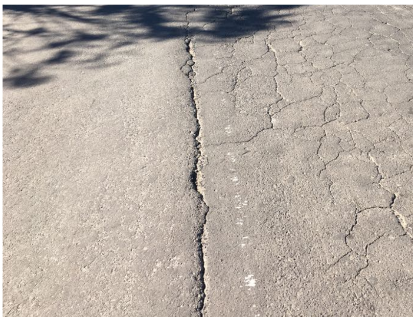
Fotografia 11 - Trinca de Retração (TR)
