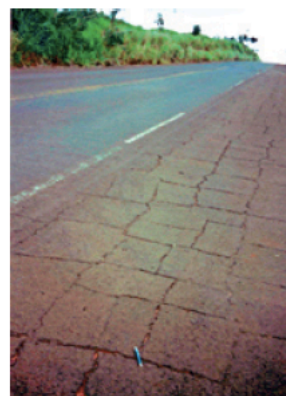
(f) Trincas de bloco sem erosão (TB)
