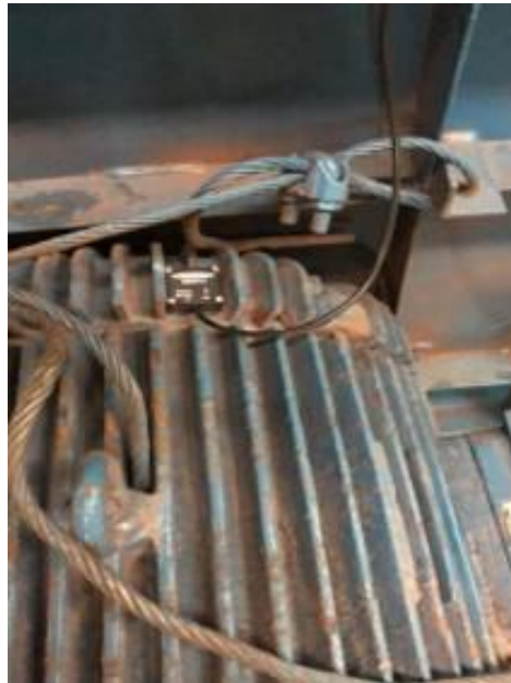
Figura 19 – Fotografia externa do sensor instalado em um exaustor industrial.
