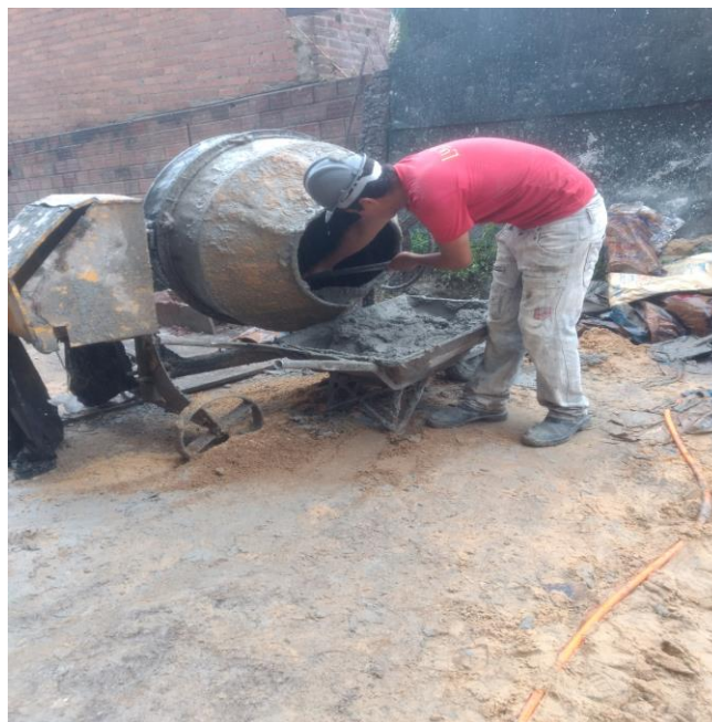
Figura 25 – Central de argamassa Obra 1
