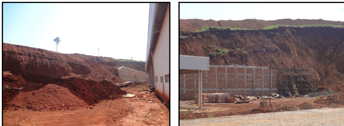
Fotografia 1 - Muro tombado durante a fase de execução
