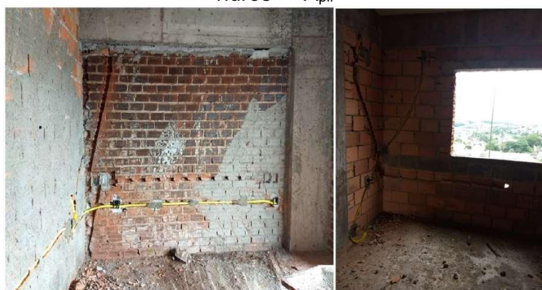
Figura 42 – Falta de revestimento interno, esquadrias e vidros – “A pil ”
