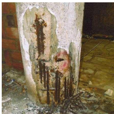
Figura 60 – Corrosão de armadura em pilar do térreo – “Bloco frontal” – “B pil ”
