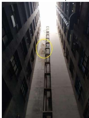
Figura 81 – Deslocamento do revestimento externo – “C pil ”
