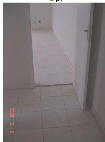
Figura 92 – Desnível no piso – “D pil ”
