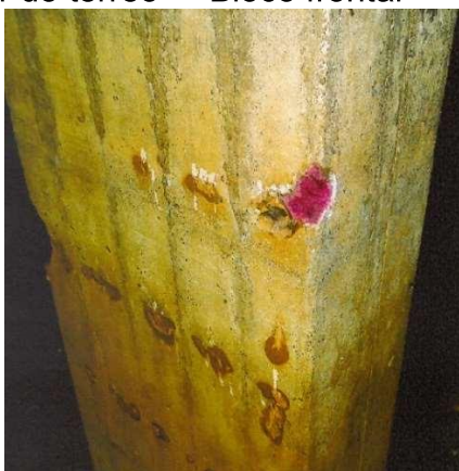
Figura 63 – Ensaio de alcalinidade em pilar do térreo – “Bloco frontal” – “B pil ”
