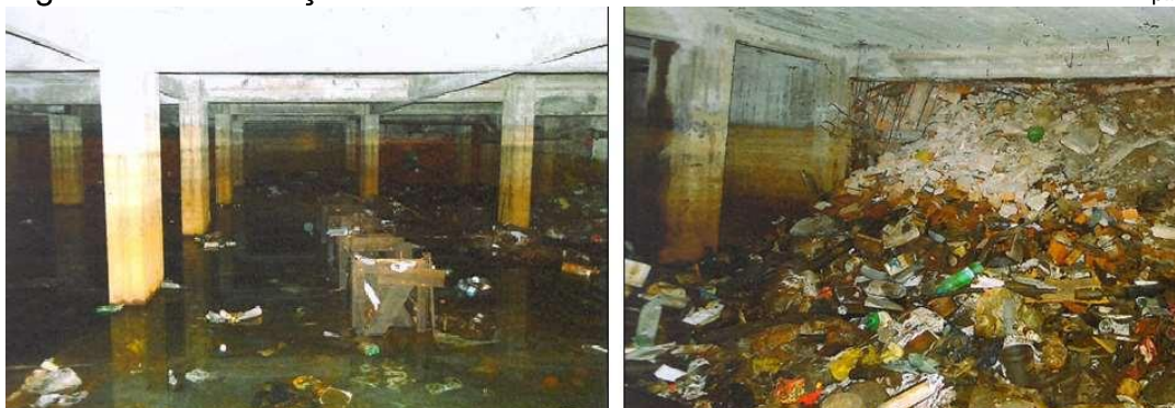
Figura 62 – Inundação e acúmulo de lixo no subsolo – “Bloco frontal” – “B pil ”
