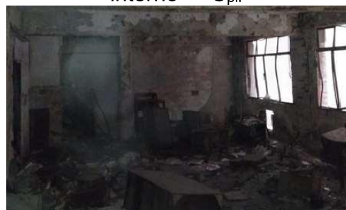
Figura 80 – Necessidade de recuperação total do revestimento interno – “C pil ”
