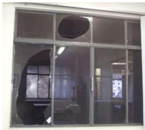
Figura 78 – Vidros vandalizados – “Cpil”
