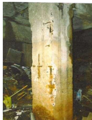
Figura 61 – Exposição de armadura em pilar do subsolo – “Bloco frontal” – “B pil ”
