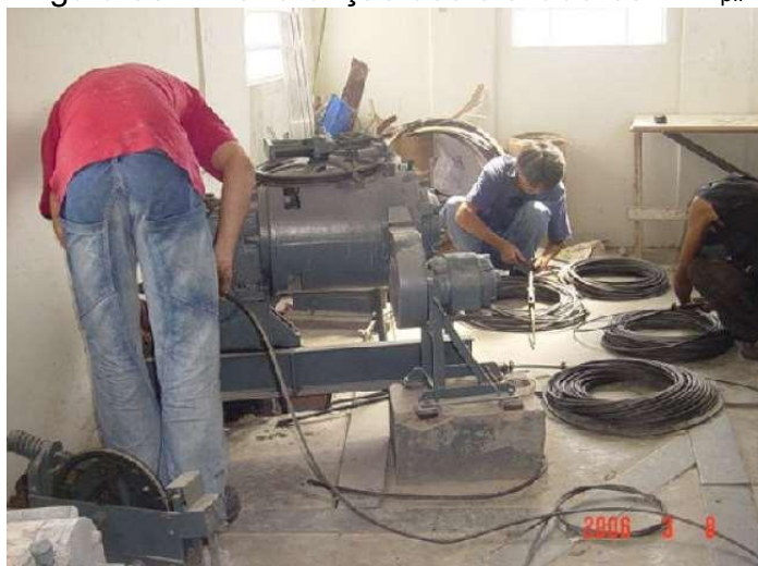
Figura 98 – Manutenção dos elevadores – “D pil ”
