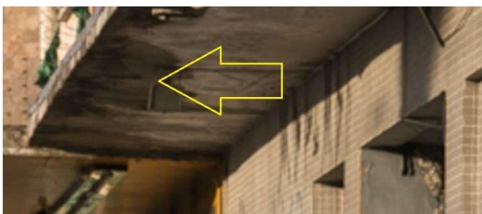
Figura 79 – Necessidade de impermeabilização da marquise – “C pil ”
