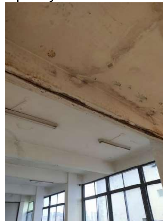
Figura 82 – Necessidade de recuperação de forros – “C pil ”
