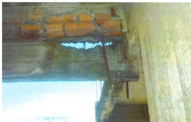
Figura 52 – Falha de concretagem em viga do “Bloco dos fundos” – “B pil ”
