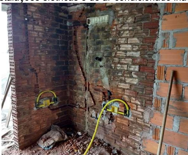
Figura 44 – Instalações elétricas e de ar-condicionado inacabadas – “Apil”
