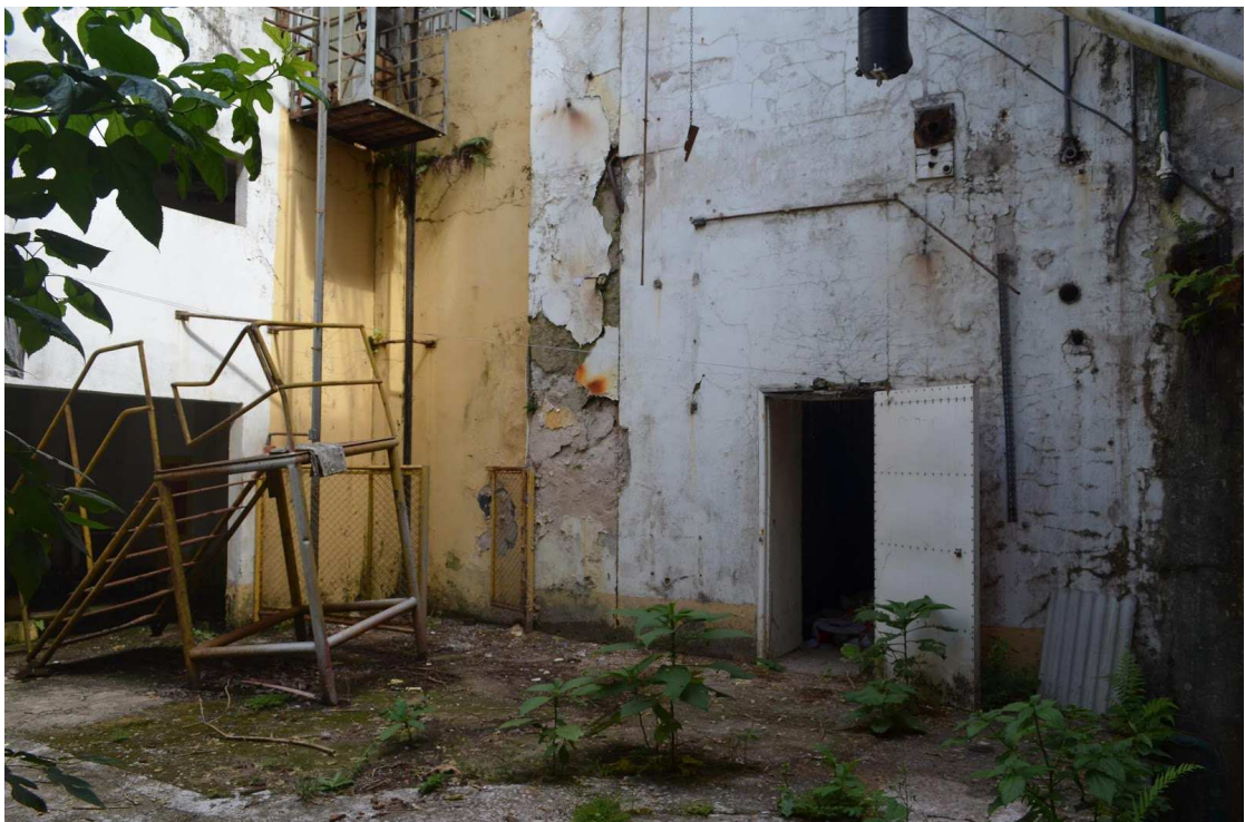
Fotografia 13 - Plantas crescem em meio ao concreto pela falta de manutenção
