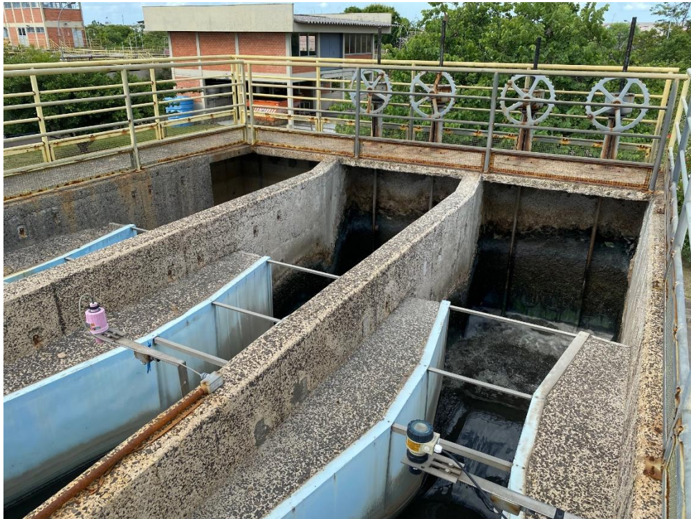
Figura 10 – Calhas Parshall do desarenador (ponto de coleta “P1-Marrom”)
