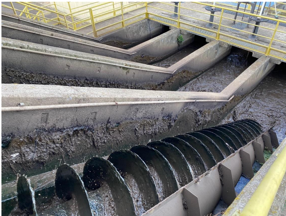
Figura 13 – Bombas parafuso para recirculação de lodo
