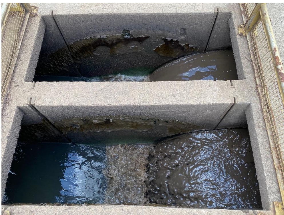
Figura 14 – Calha de distribuição dos reatores; o lodo recirculado (à direita) se mistura ao afluente bruto (à esquerda). O ponto P5 refere-se ao lodo recirculado
