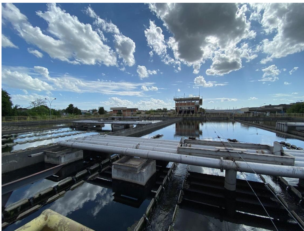
Figura 12 – Decantadores secundários e calhas de coleta (ponto de coleta “P4-Azul”)
